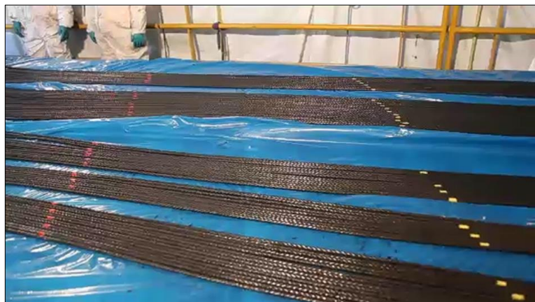
Figura 55. Cables marcados con cintas
