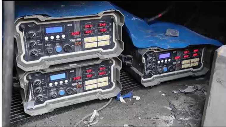
Figura 71. Tableros de control para regular temperatura.
