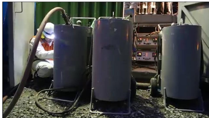
Figura 72. Bombas para regular presión de las bolsas.
