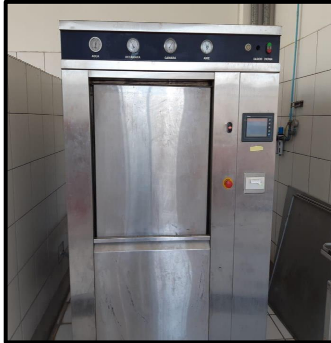
Imagen N° 01: Sistema de Autoclave del HSMSI para el tratamiento de biocontaminados
