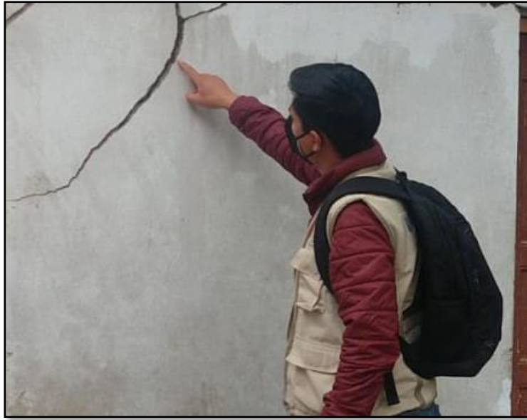
Figura N°52: paredes con fisuras menores a 2 milímetros.
