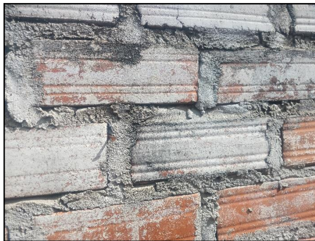
Figura N°27: paredes con espesor de juntas de 2 a 3 cm.
