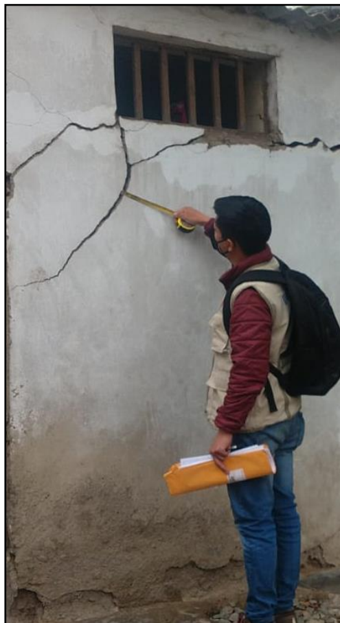
Figura N°53: paredes con fisuras entre 2 a 3 milímetros.
