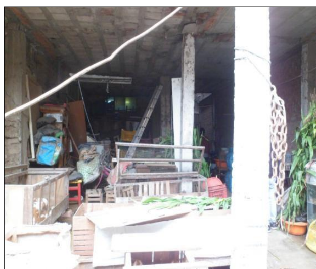
Figura N°41: Viviendas con problema de piso blando
