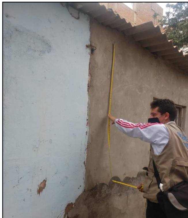
Figura N°47: Cubierta inestable que no aseguran un comportamiento de diafragma rígido.
