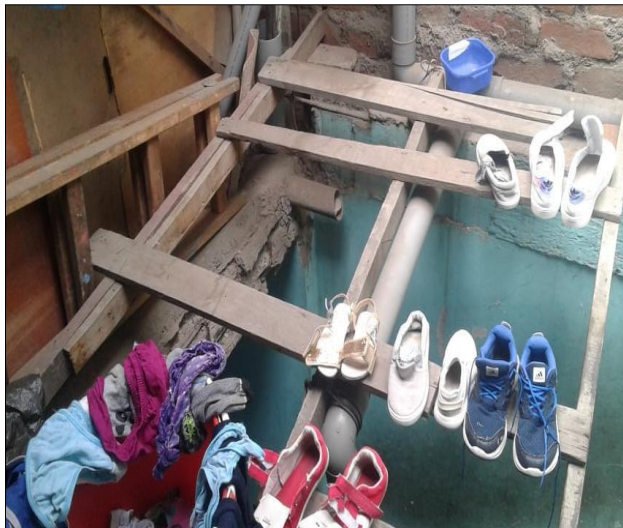
Figura N°50: Elementos precarios mal conectados a la estructura.
