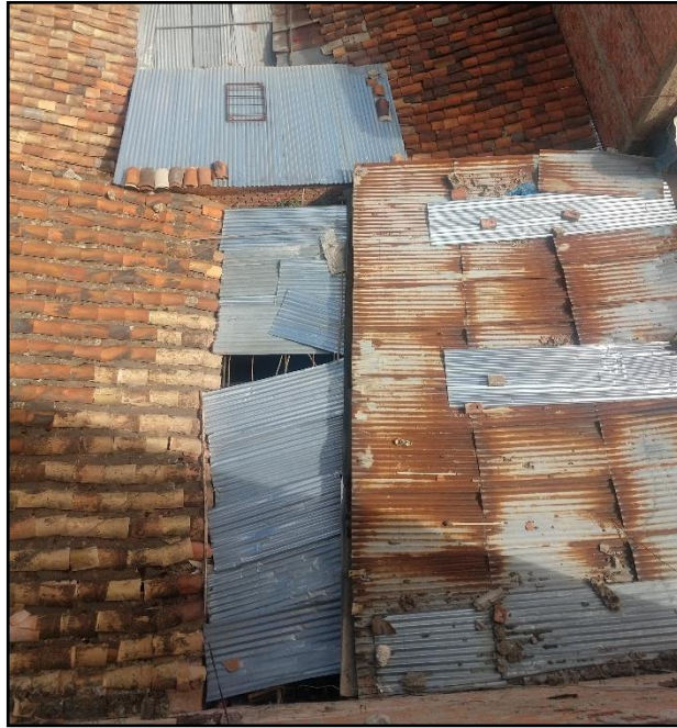
Figura N°46: Cubierta inestable que no aseguran un comportamiento de diafragma rígido.
