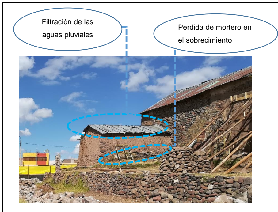
Figura 31: Patologías sacristía Fuente: Elaboración Propia
