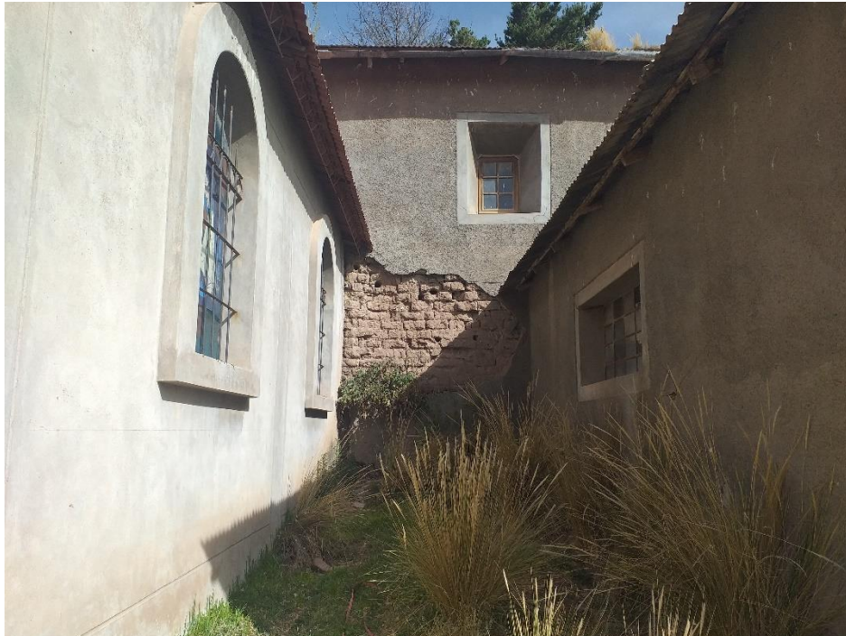
Figura 20: Muro estructural erosionado
