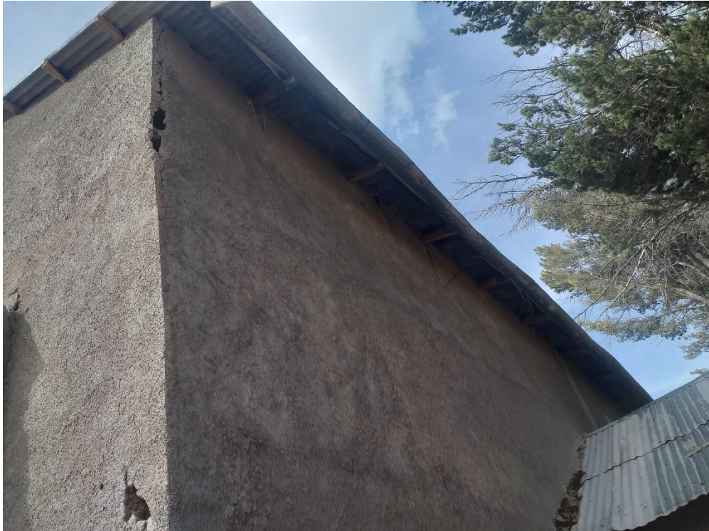
Figura 13: Falla de tracción en el encuentro de muros
