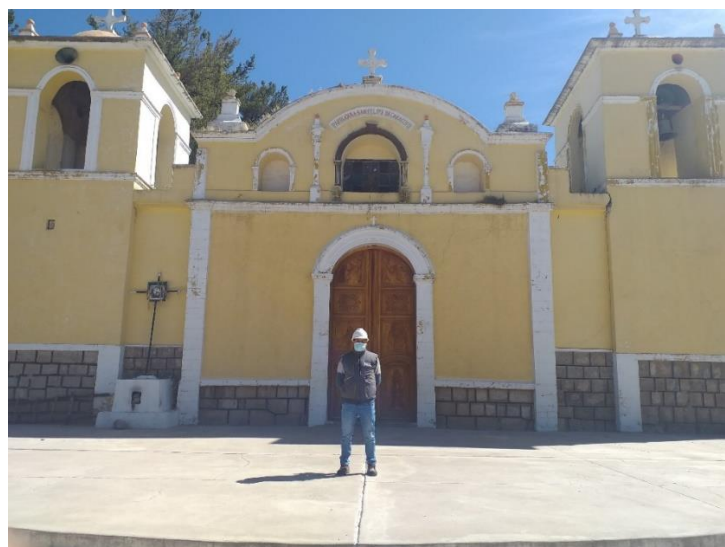
Figura 16: Fisuras en la tabiquería externa del Templo
