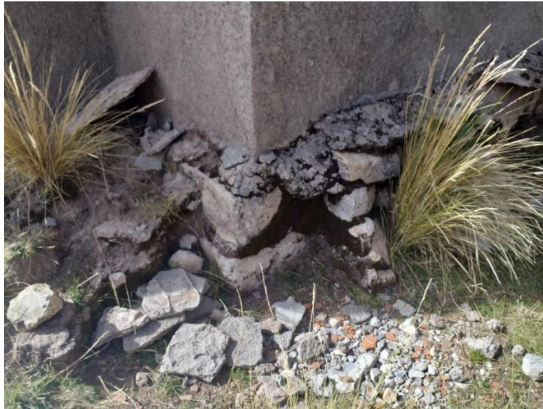
Figura 17: Erosión del Suelos en la cimentación
