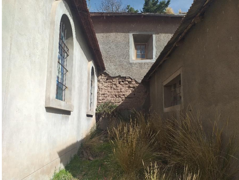
Figura 23: Muro erosionado expuesto a la intemperie
