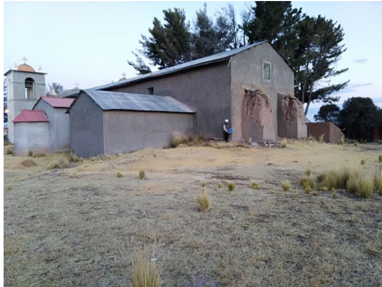
Figura 19: Erosión en los contrafuertes posteriores del Templo
