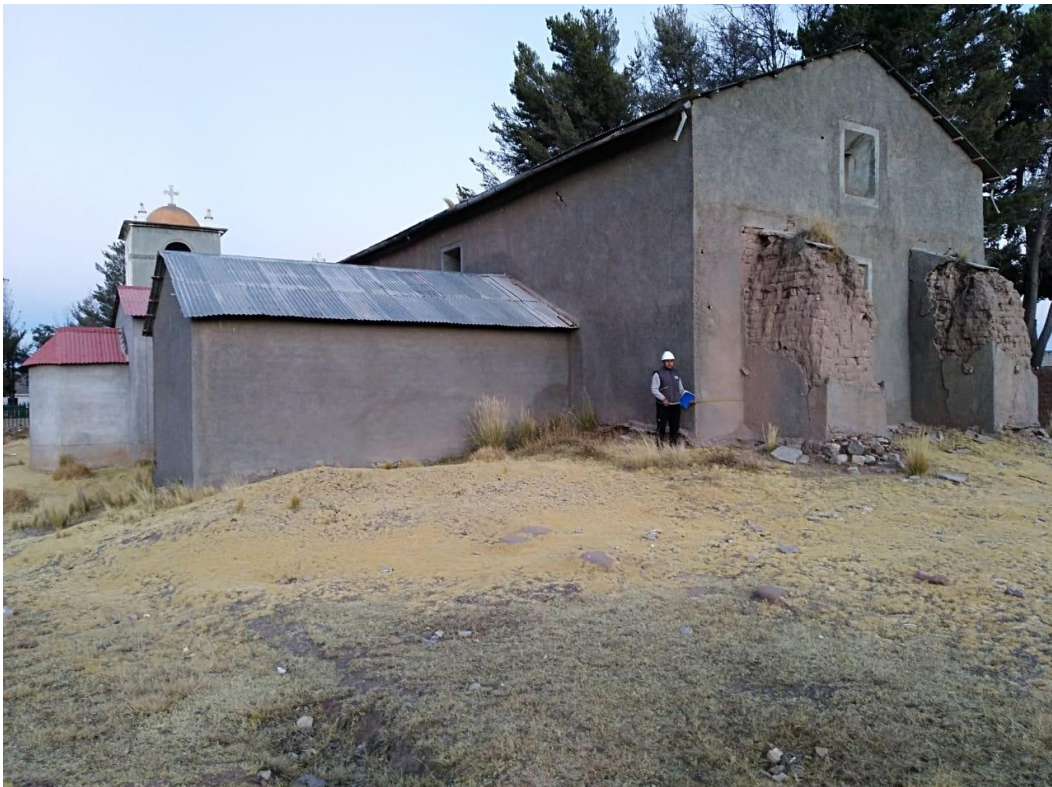
Figura 24: Contrafuerte erosionado y expuesto a la intemperie
