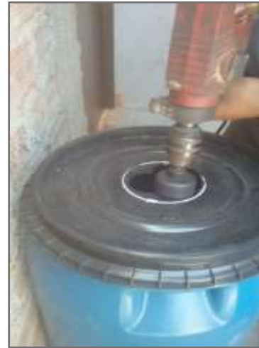
Figura 55 Perforación de la Tapa de Ingreso de Materia Orgánica
