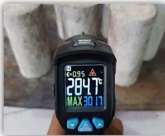
Fisura N°173– Temp. Prob.
