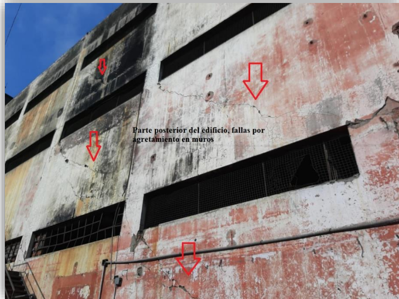
Figura N°25. Fallas en los muros de la parte posterior de la edificación
