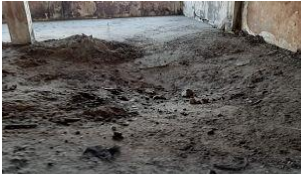
Figura N° 255 – Daños en losa de techo y paredes del edificio Nicolini.
