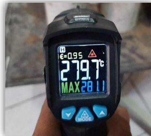
Fisura N°174 – Temp. Prob.
