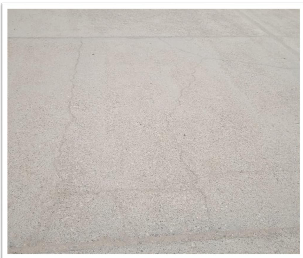
FOTOGRAFÍA 7: FALLAS EN EL CONCRETO HIDRÁULICO
