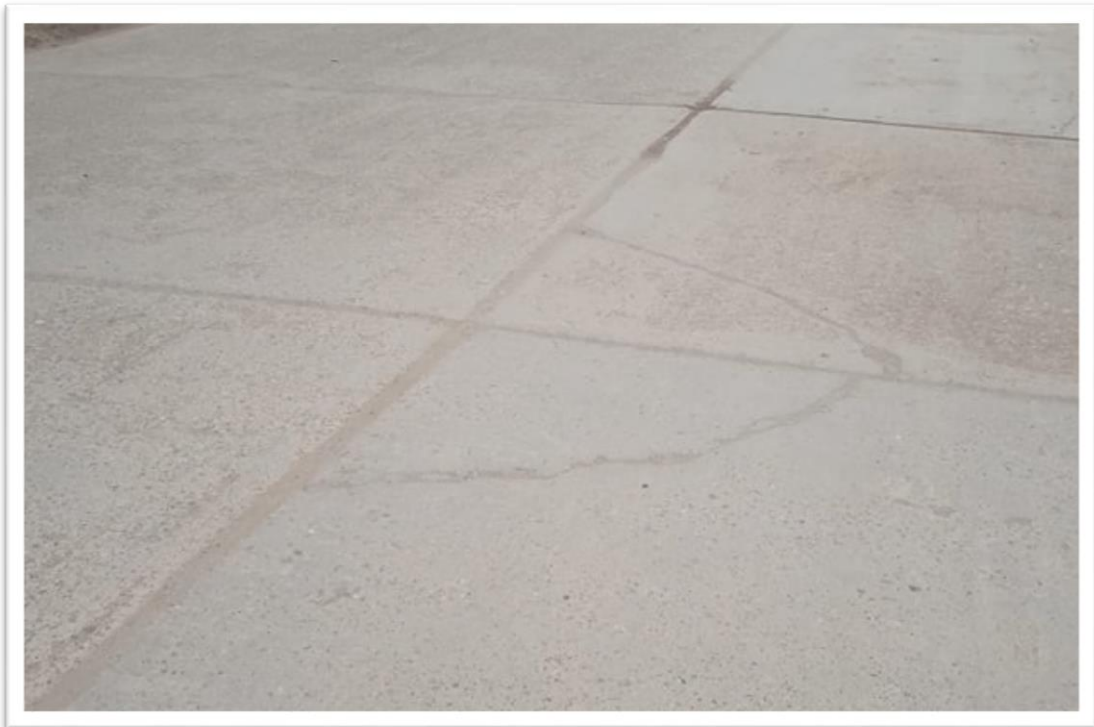
FOTOGRAFÍA 6: FALLAS EN EL CONCRETO HIDRÁULICO
