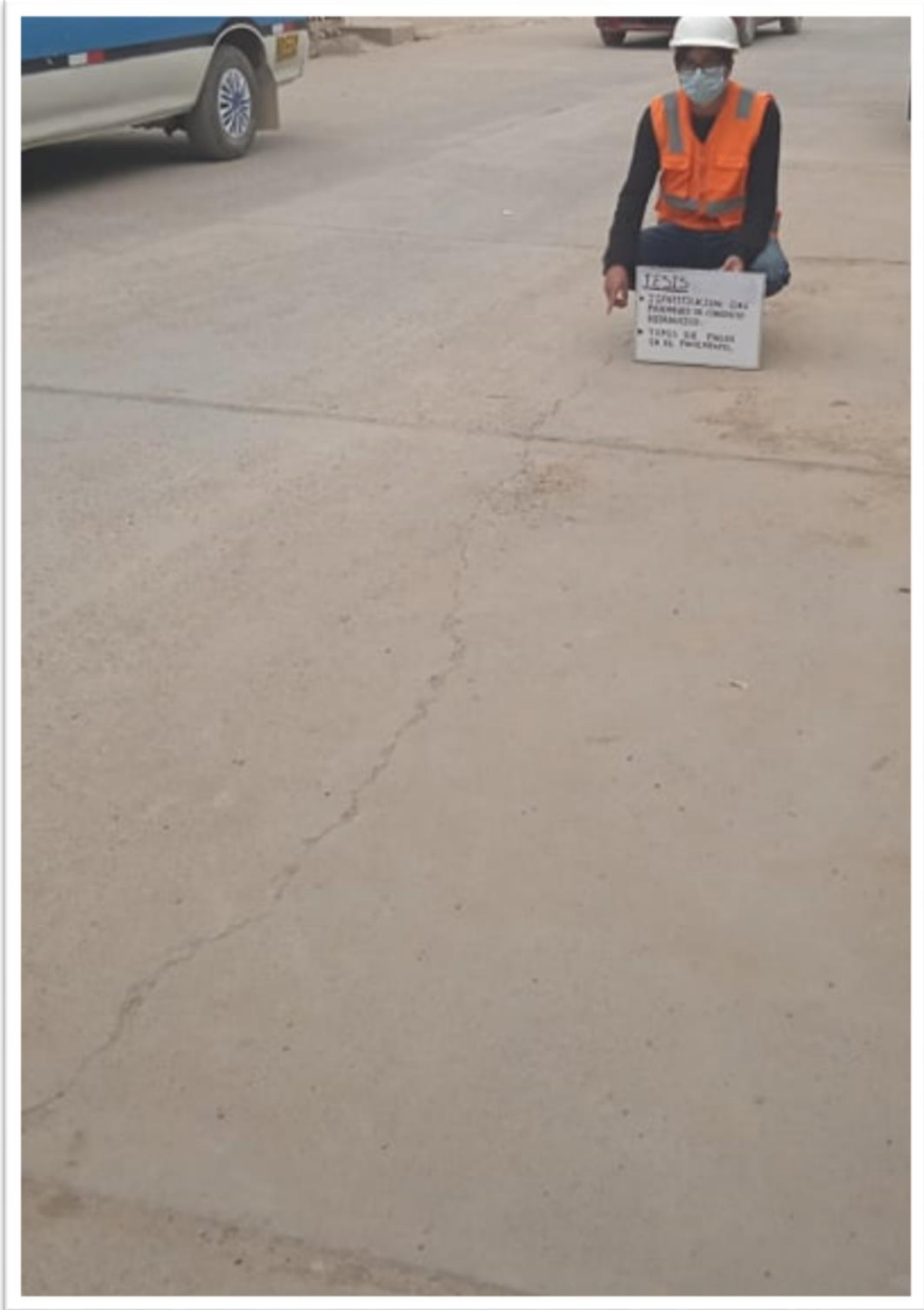
FOTOGRAFÍA 5: IDENTIFICACIÓN DE FALLAS
