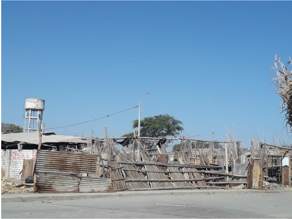
Figura 9. Cercos perimétricos por colapsar.
