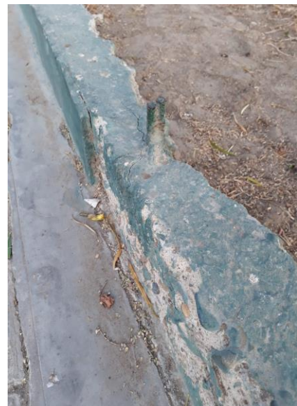
Figura 4. Deterioro de cercos
