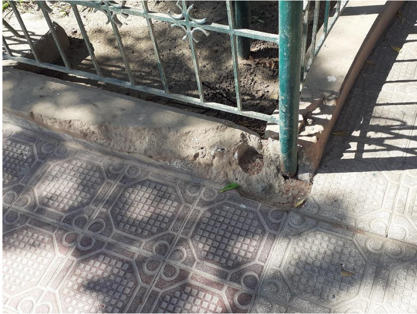
Figura 3: Encuentro entre la reja y el sardinel de la plaza Tres Culturas del distrito de Piura.
