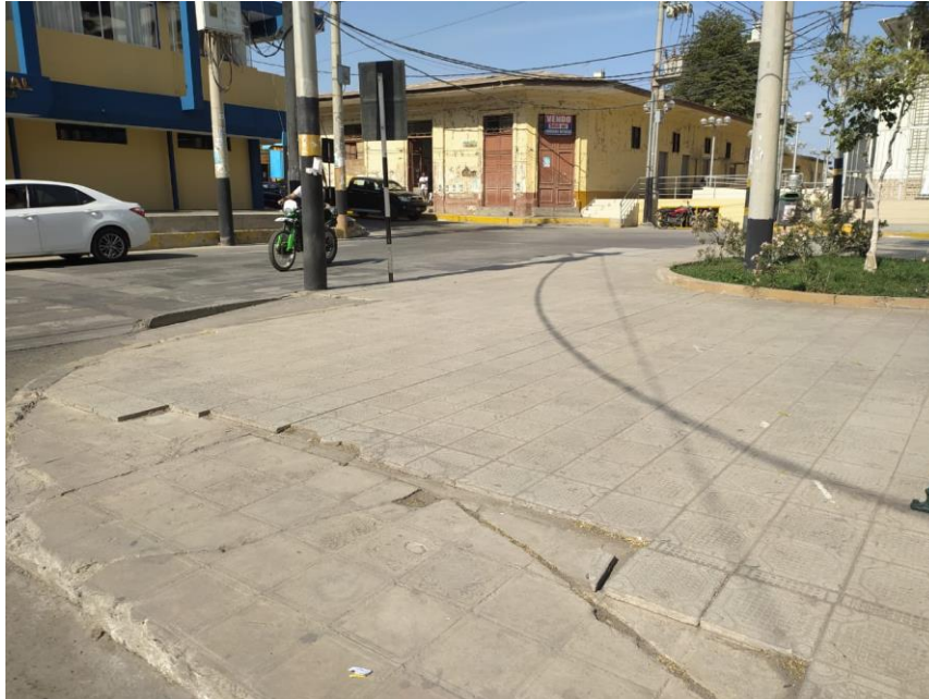
Figura 7: Baldosas de concreto y sardinel de la plaza Tres Culturas del distrito de Piura.
