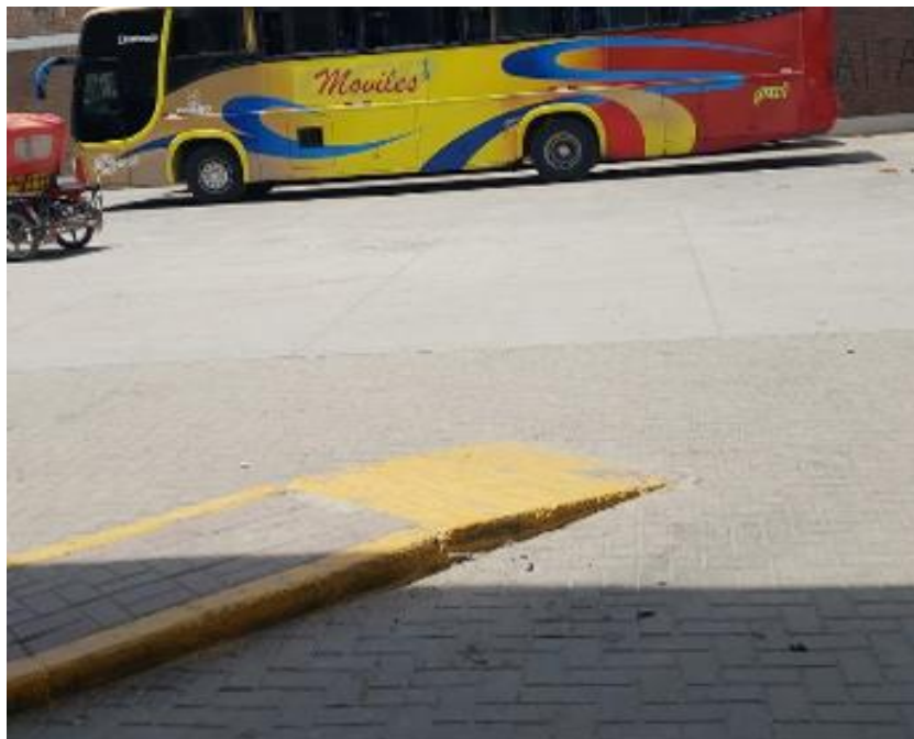
Figura N°01: Deterioro de rampas y ausencia de mantenimiento en empresa de transporte para personas que presentan discapacidad. Empresa Gechiza. Piura, 2021.
