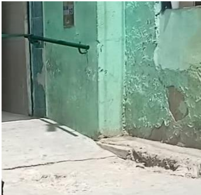
Figura N°06: Deterioro de las vías de circulación, ingreso al equipamiento y rampas; Empresas Dora. Piura, 2021.
