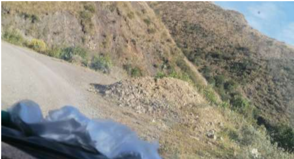
Figura 6. Se puede observar en la vía a nivel afirmado que hay materiales extraños que necesitan ser removidos.
