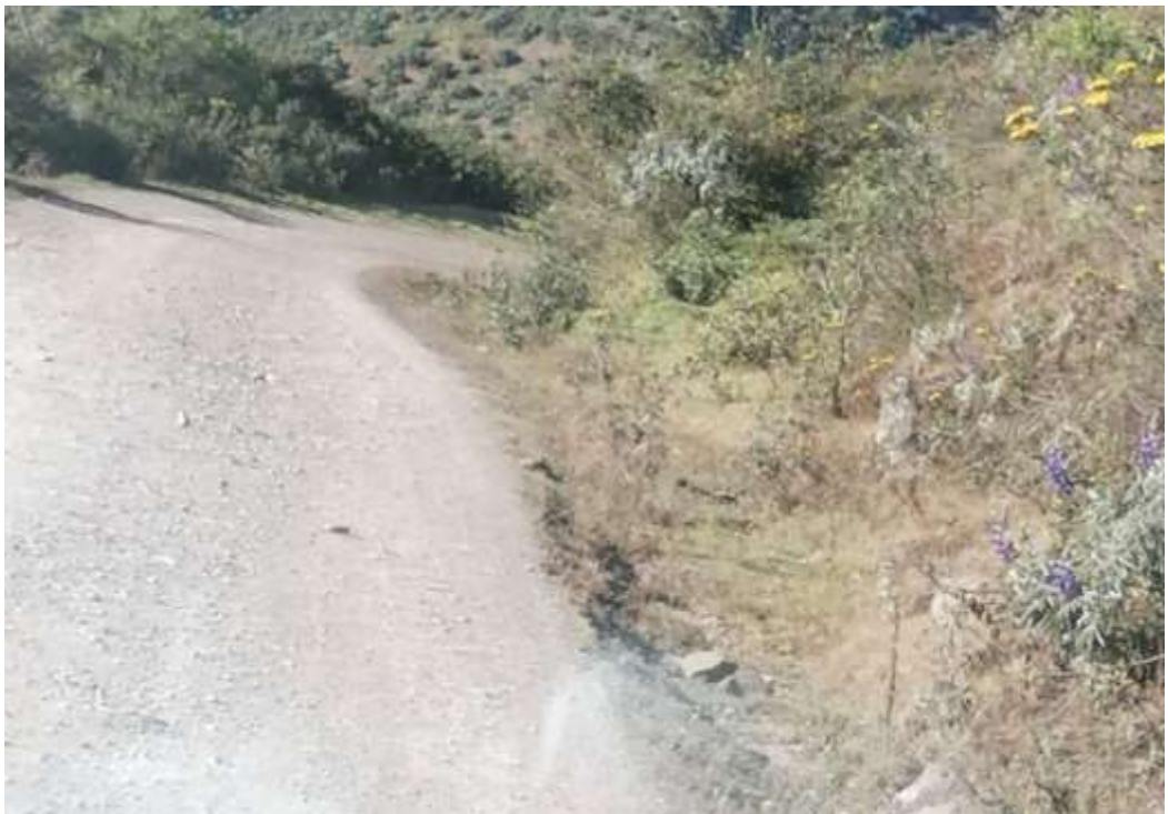
Figura 8. Se puede observar en algunos tramos de la vía que los bordes de la plataforma de afirmado han sufrido asentamientos o deformación y necesitan ser reparados.
