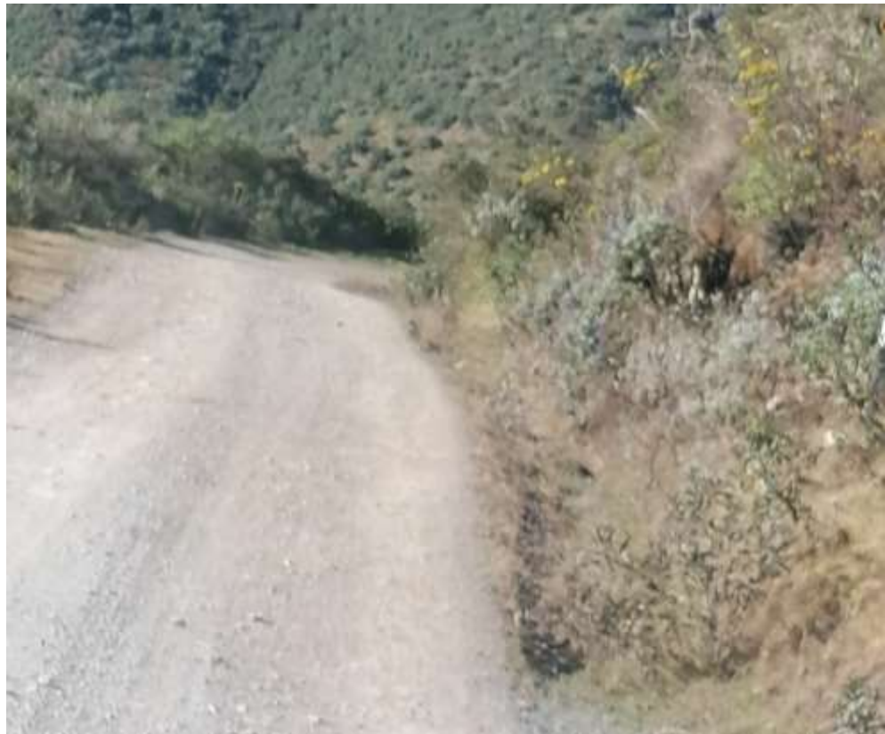
Figura 4. Se puede observar en algunos tramos de la vía que no existe alcantarillas ni cunetas.
