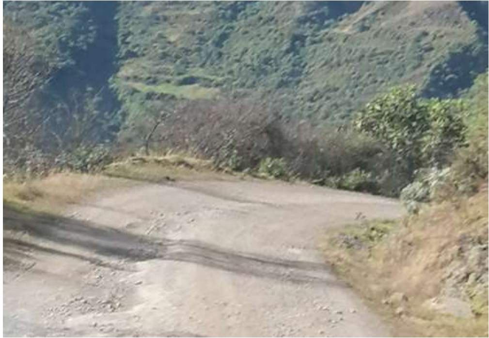
Figura 3. Se observa y percibe irregularidades o baches en casi todo el tramo de la carretera.
