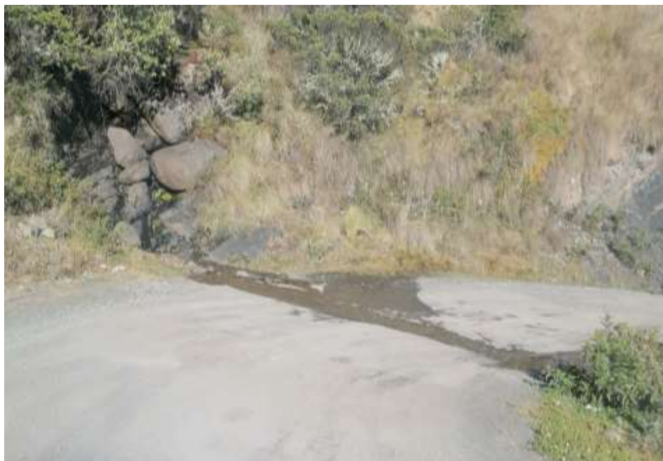
Figura 2. Se observa cauces de agua que atraviesan la carretera en algunos tramos de la vía.
