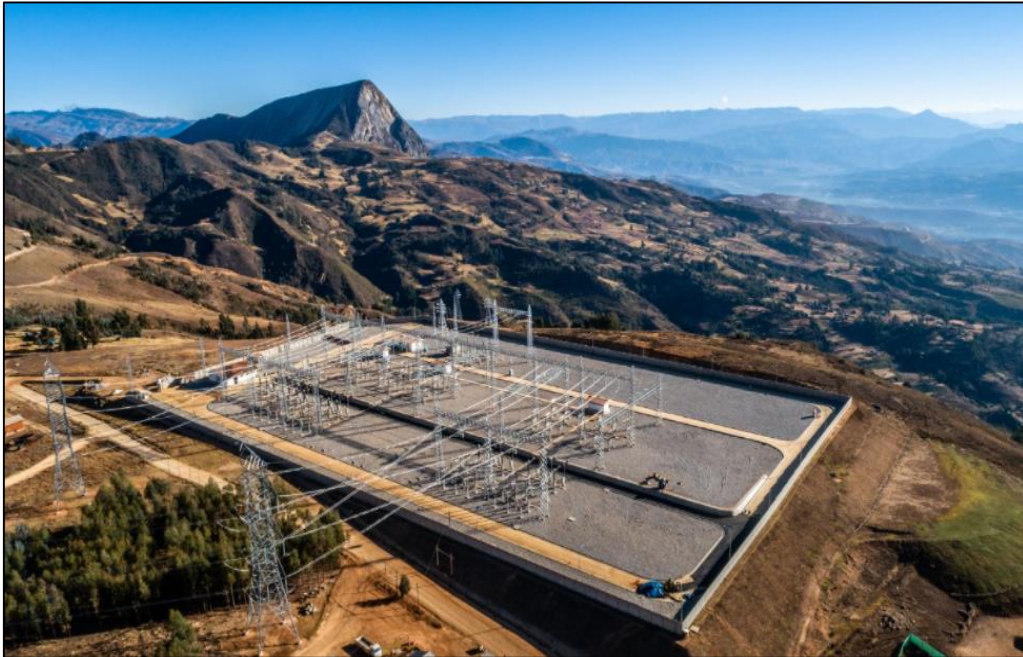
Fotografía 17: Subestación Pampa Honda (LT 220 kv)
