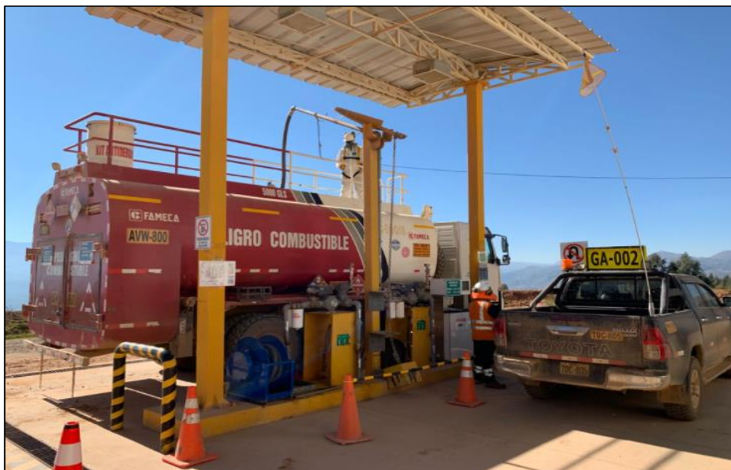
Fotografía 4: Cisterna para recarga de combustible en operación
