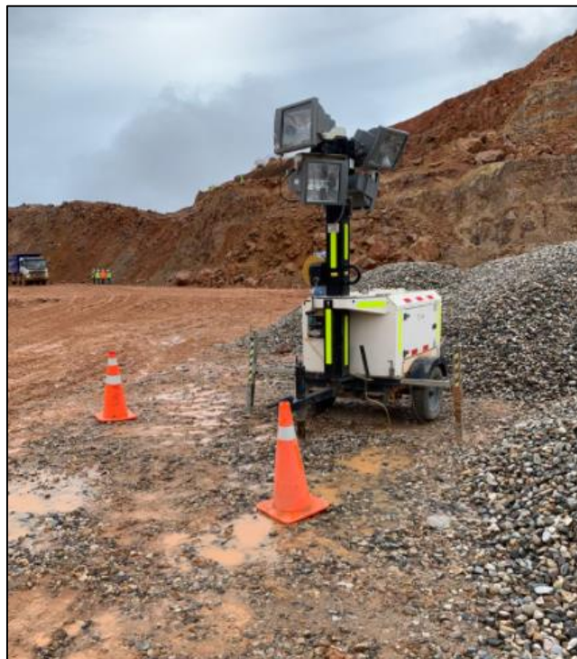
Fotografía 14: Luminarias a diesel
