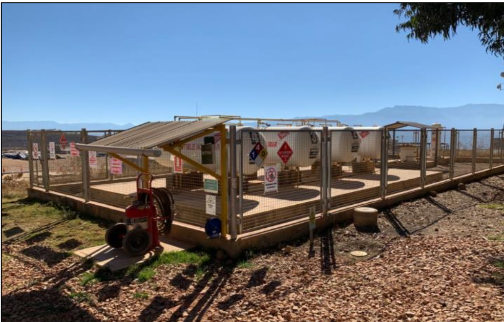
Fotografía 2: Tanques GLP para cocina
