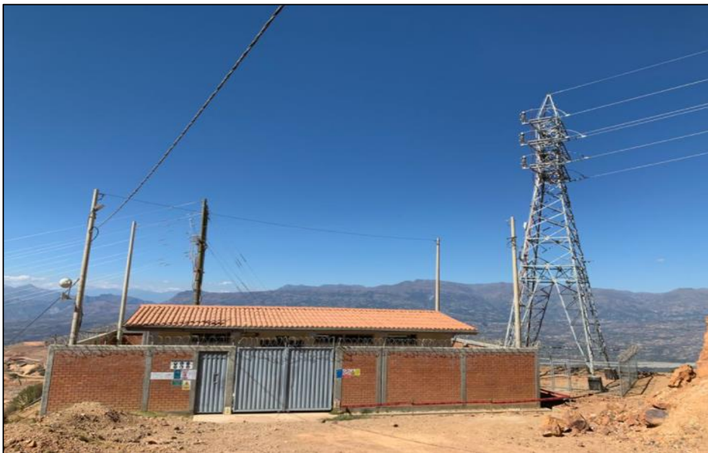
Fotografía 18: Subestación Shahuindo (LT 22.9 kv)
