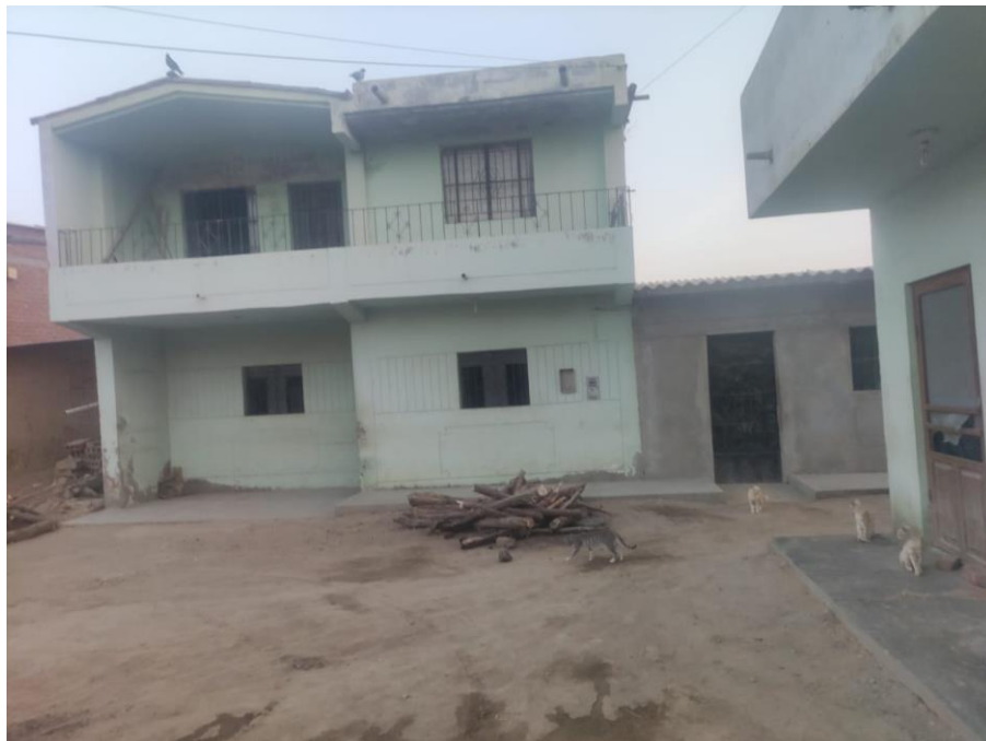
Anexo 16. Vivienda de dos niveles evaluada, en donde se puede apreciar ausencia de junta sísmica – sector 25 de enero
