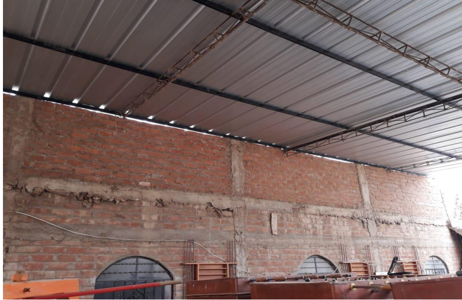
Anexo 15. Vivienda que presenta cangrejas en vigas y errores en el asentado de ladrillo – sector 25 de enero
