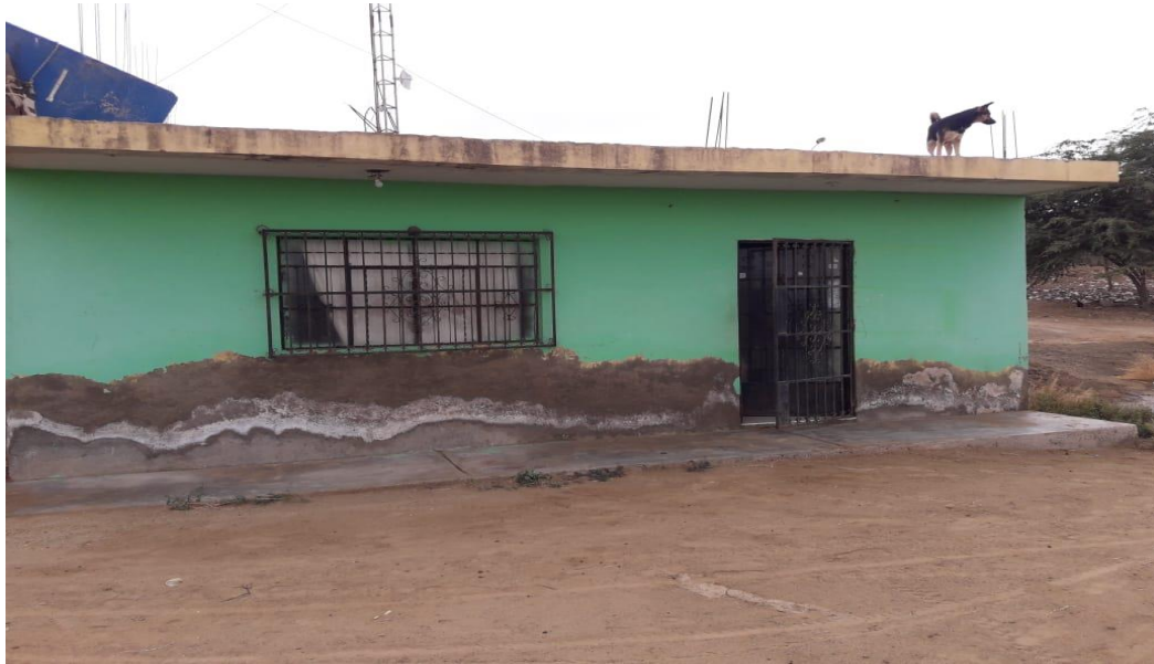
Anexo 13. Vivienda con deterioro en las paredes a causa del salitre- sector nueva esperanza
