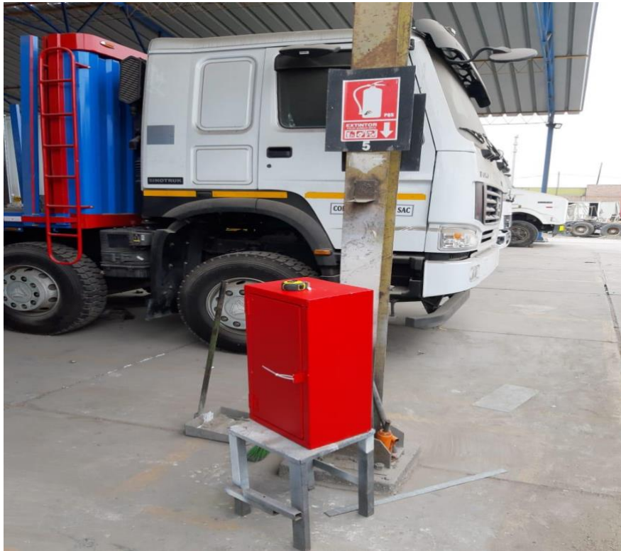
Figura 55. Implementación de Porta Extintores
