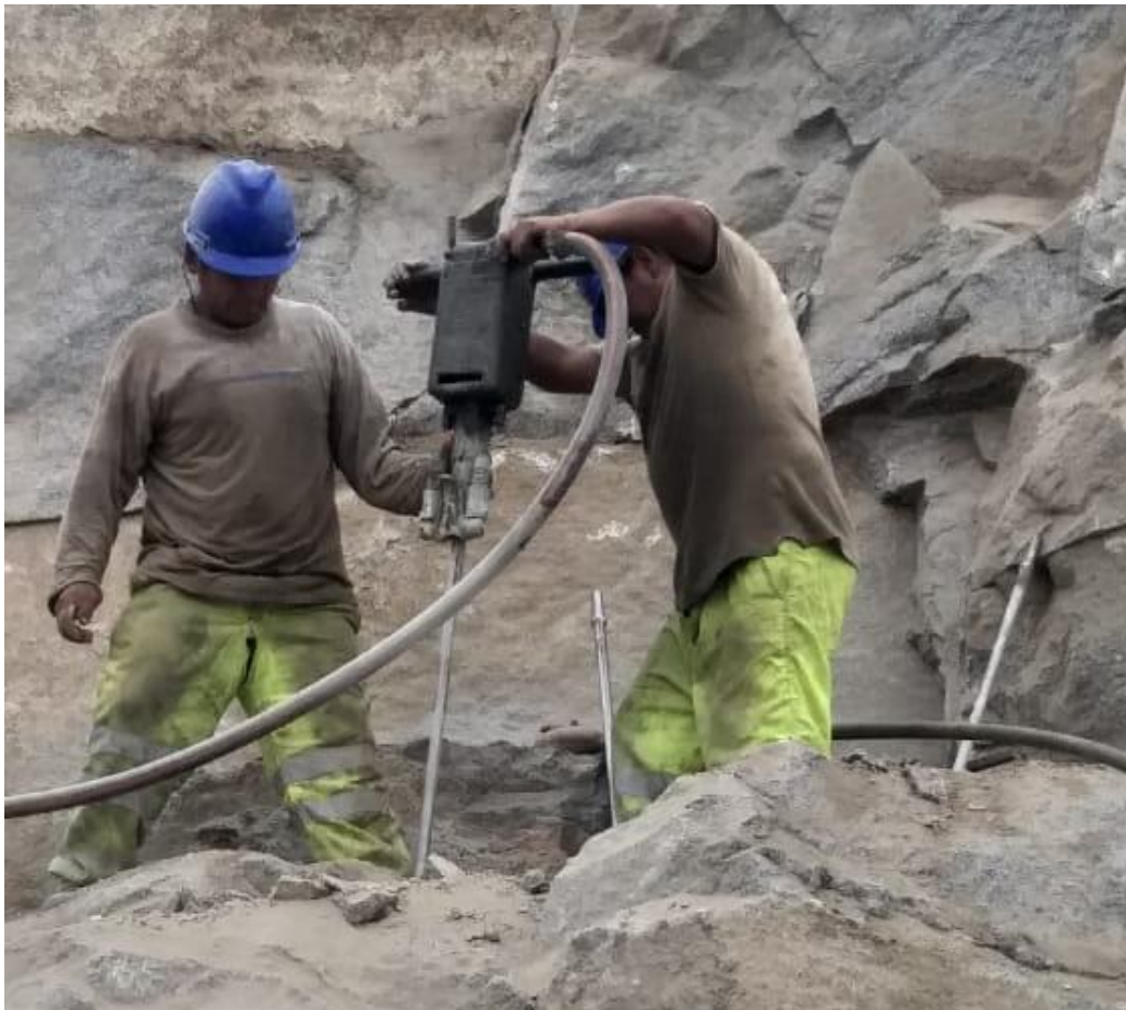
Figura 4: Deficiencias en perforación extracción de caliza. Fuente: Elaboración propia.
