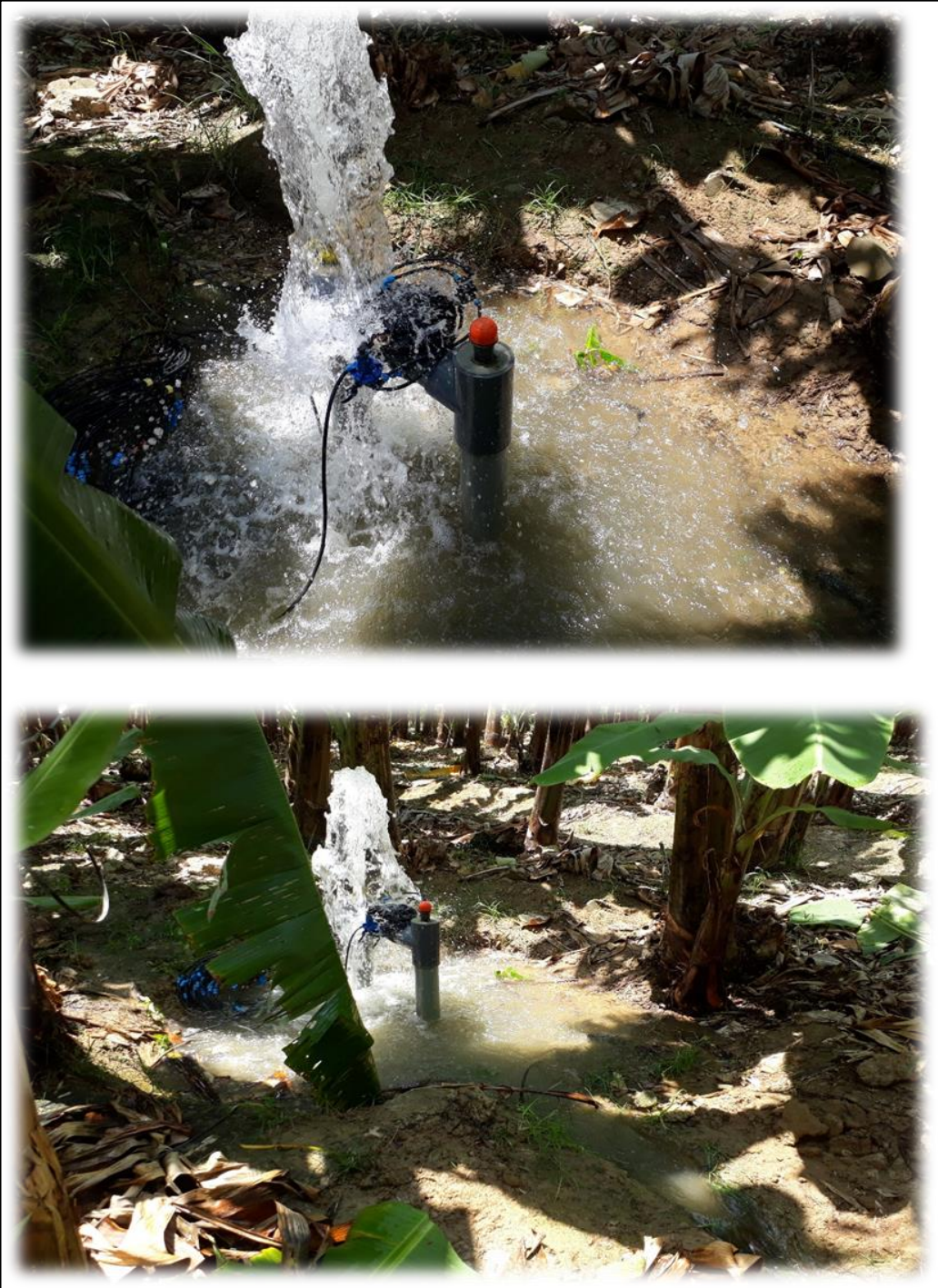
Figura 10: Muestra una fuga de agua en la válvula 01.
