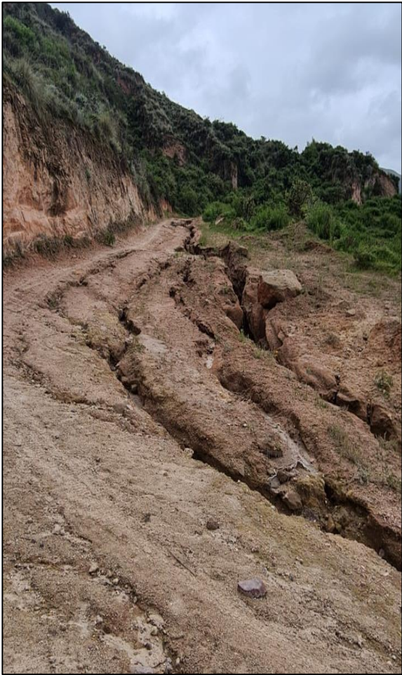
Foto 01: Vías dañadas en avenida de lluvias
