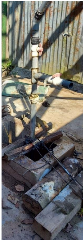
La tapa de protección al pozo tubular no es la adecuada, y los accesorios de la línea de impulsión están deteriorados.
