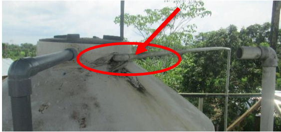
Vista de la línea de rebose en pésimas condiciones de instalación.
