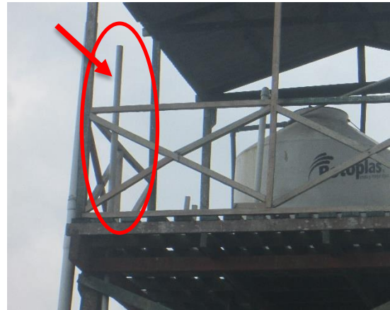
Se puede observar la falta de sombrero de protección en el tubo de ventilación.
