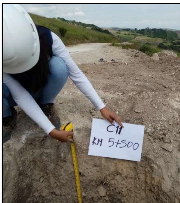
Figura 20: Las Guineas- Mañumal, Excavación de Calicata 11 (km. 5+500), por extracción de muestra de suelo, evidencia fotográfica, 2021.
