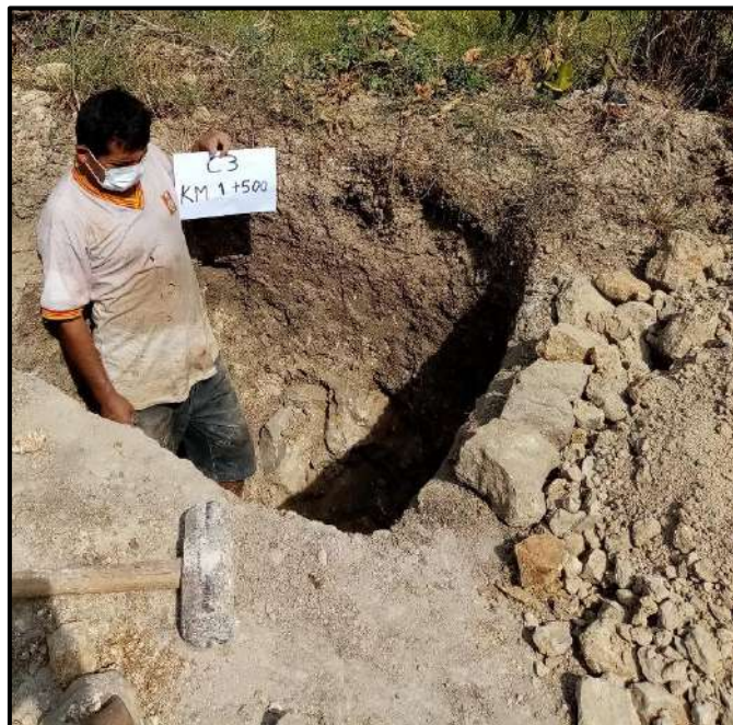
Figura 13: Las Guineas- Mañumal, Excavación de Calicata 3 (km. 1+500), por extracción de muestra de suelo, evidencia fotográfica, 2021.
