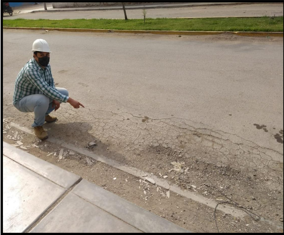
ILUSTRACIÓN 11: PIEL DE COCODRILO Y SEPARACIÓN DE AGREGADOS.
