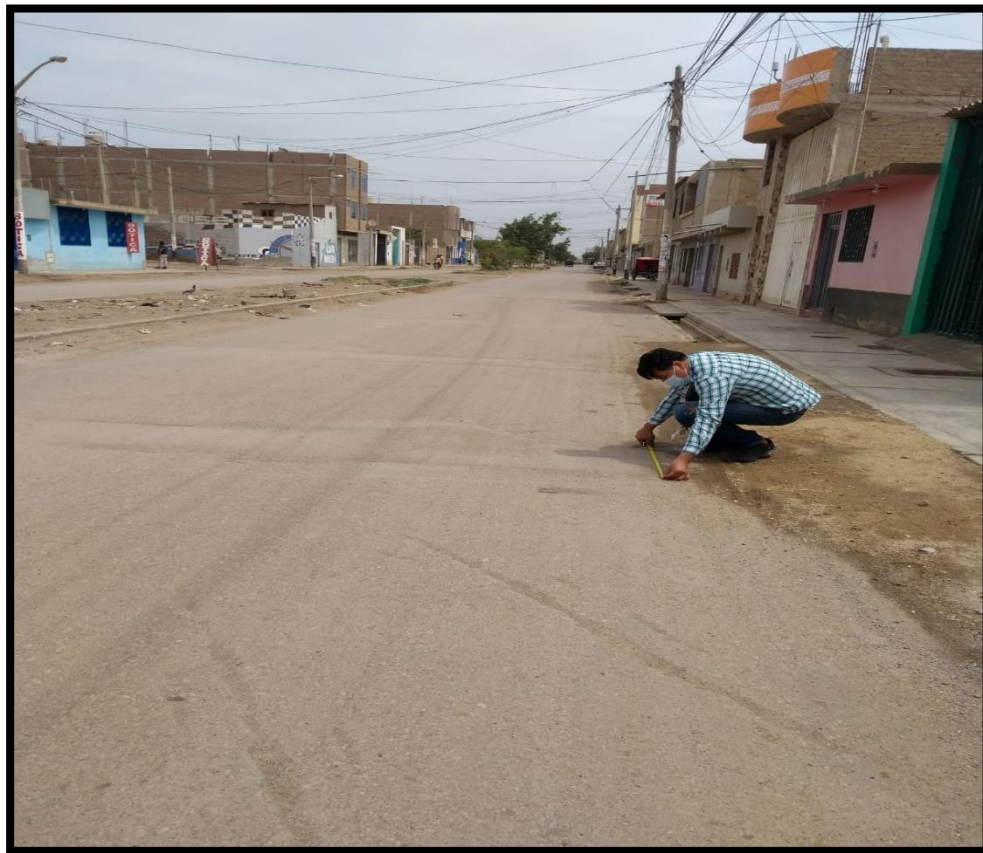
ILUSTRACIÓN 24: PARCHEO, GRIETAS LONGITUDINALES.
