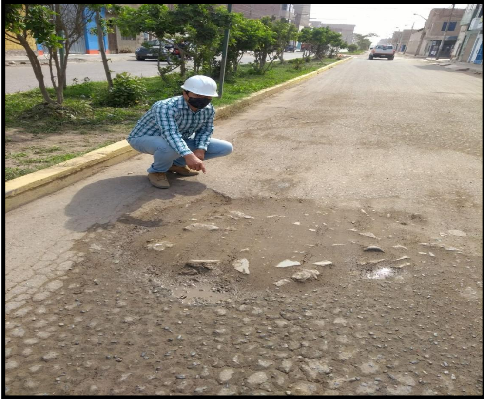
ILUSTRACIÓN 29: PIEL DE COCODRILO, HUNDIMIENTO, DESPRENDIMIENTO DE AGREGADOS.
