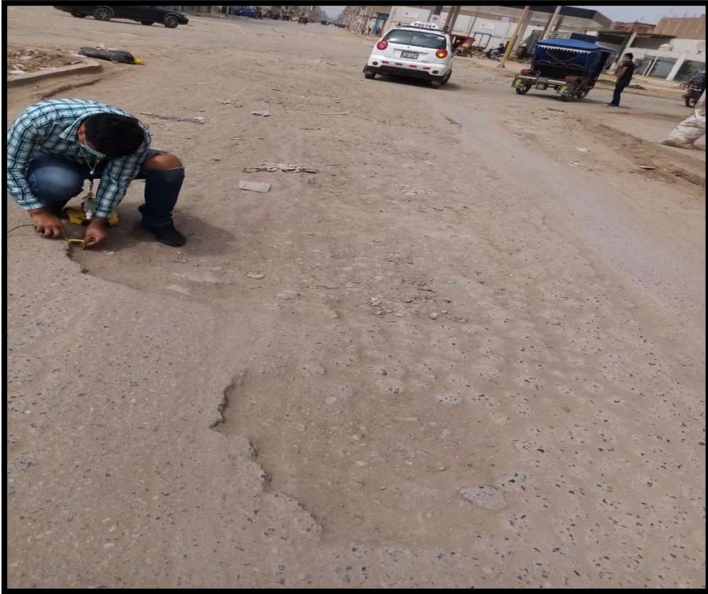
ILUSTRACIÓN 59: HUECOS, DESPRENDIMIENTO AGREGADOS.
