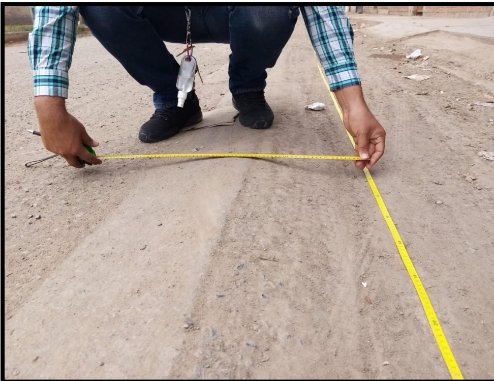
ILUSTRACIÓN 56: ABULTAMIENTO, GRIETAS DE BORDE.
