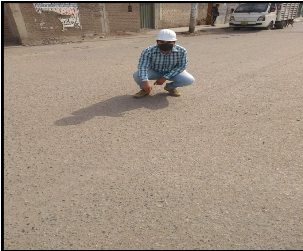
ILUSTRACIÓN 14: PULIMIENTO DE AGREGADOS Y AGRIETAMIENTO.
