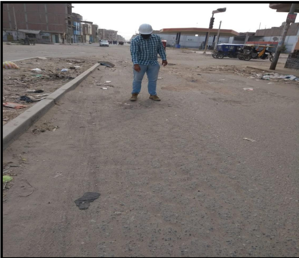
ILUSTRACIÓN 40: GRIETAS EN BLOQUE.
