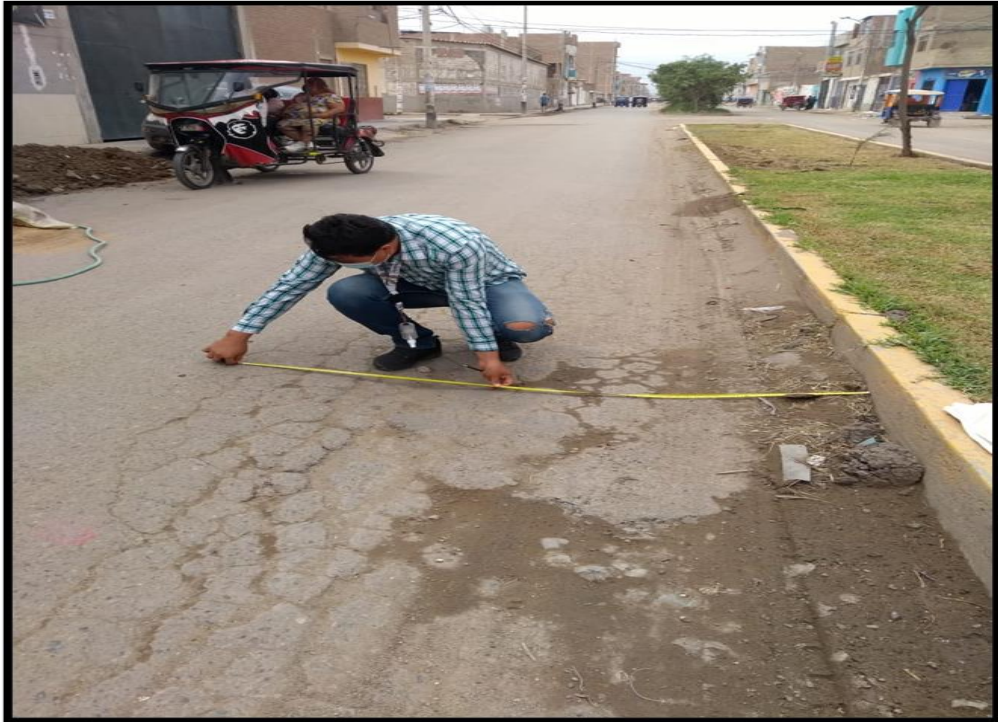
ILUSTRACIÓN 15: PIEL DE COCODRILO, AHUELLAMIENTO.
