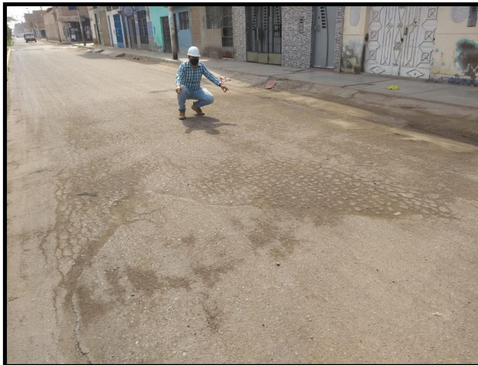
ILUSTRACIÓN 28: PIEL DE COCODRILO, GRIETAS PARABÓLICAS, PULIMIENTO DE AGREGADOS.
