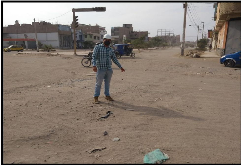
ILUSTRACIÓN 1: PRESENCIA DE HUECOS, DESPRENDIMIENTO DE AGREGADOS Y HUNDIMIENTO.
