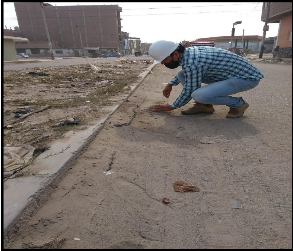
ILUSTRACIÓN 41: HUNDIMIENTO, PULIMIENTO DE AGREGADOS.
