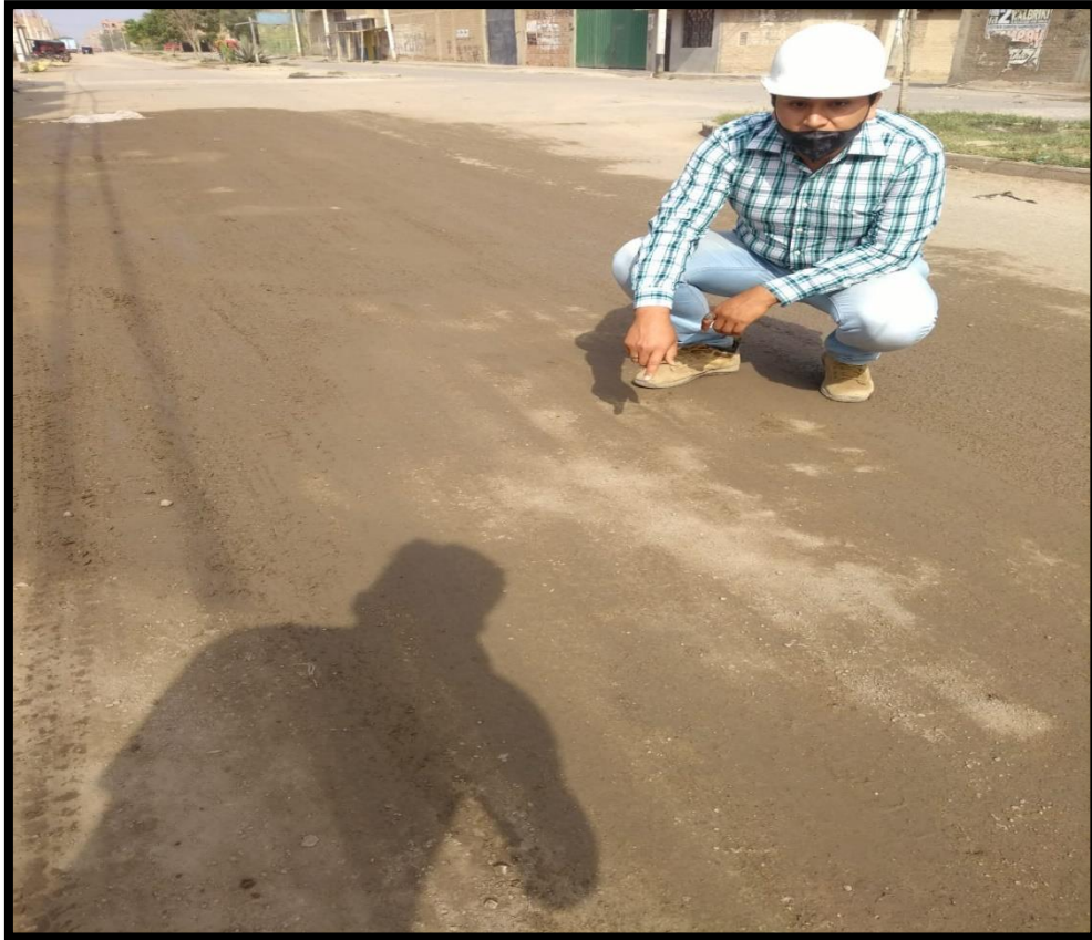
ILUSTRACIÓN 35: DESPRENDIMIENTO DE AGREGADOS.
