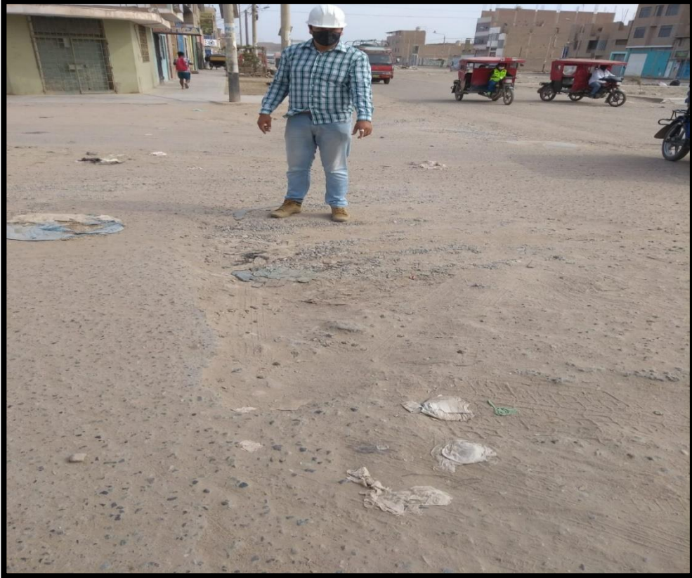
ILUSTRACIÓN 45: PULIMIENTO DE AGREGADOS, HUECOS.
