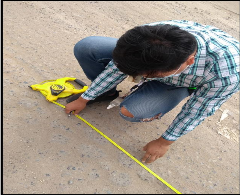
ILUSTRACIÓN 18: GRIETAS LONGITUDINALES, PULIMIENTO DE AGREGADOS.
