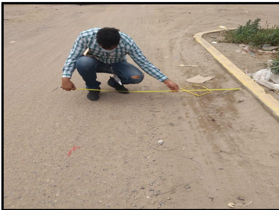
ILUSTRACIÓN 19: PULIMIENTO DE AGREGADOS, AHUELLAMIENTO.
