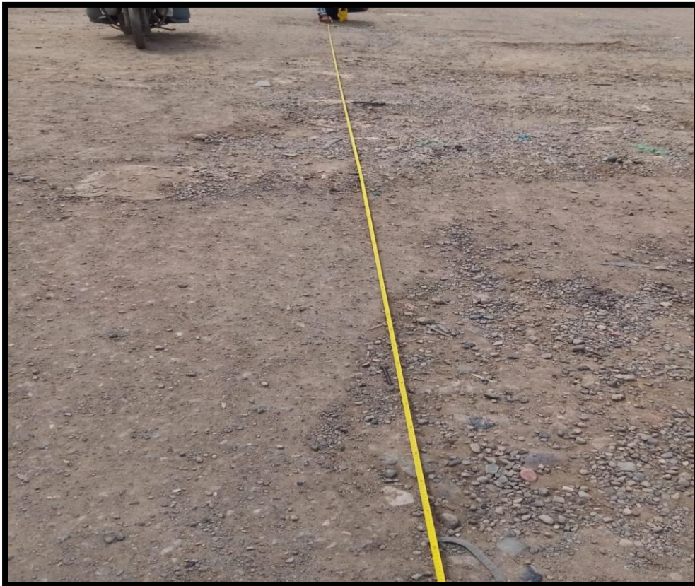
ILUSTRACIÓN 50: DESPRENDIMIENTO DE AGREGADOS.
