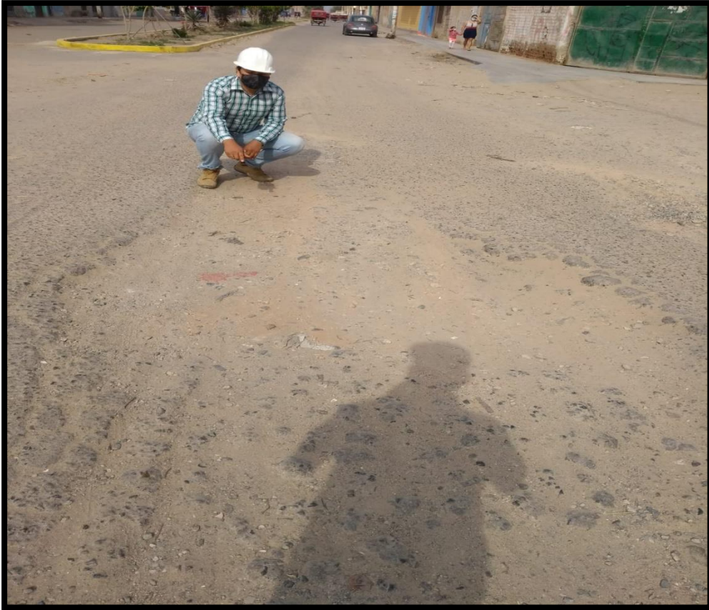
ILUSTRACIÓN 7: HUECOS, DESPRENDIMIENTO DE AGREGADOS, GRIETA LONGITUDINALES, AHUELLAMIENTO
