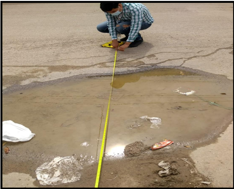
ILUSTRACIÓN 26: HUECO, GRIETAS LONGITUDINALES.
