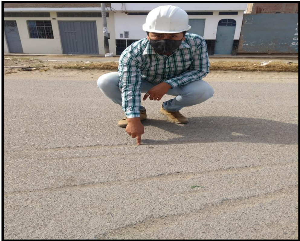
ILUSTRACIÓN 10: AGRIETAMIENTO Y HUNDIMIENTO.
