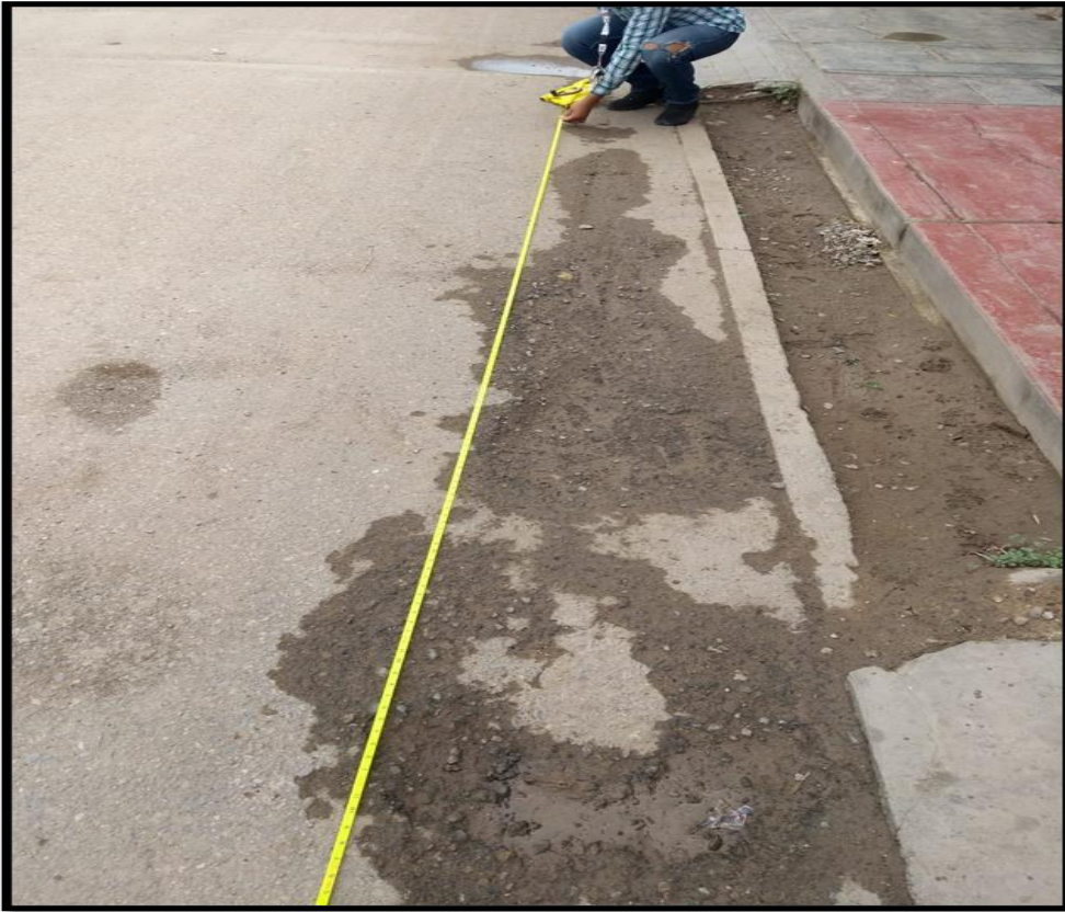
ILUSTRACIÓN 25: DESPRENDIMIENTO DE AGREGADOS.
