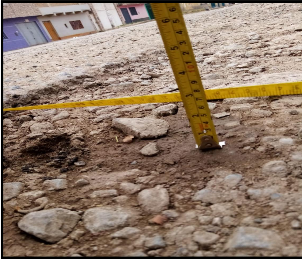
ILUSTRACIÓN 57: HUECO, GRIETA DE BORDE.
