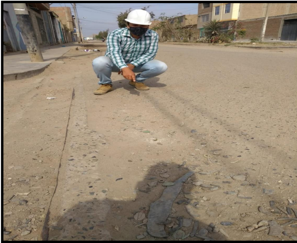
ILUSTRACIÓN 34: DESPRENDIMIENTO DE AGREGADOS Y PULIMIENTO DE AGREGADOS.
