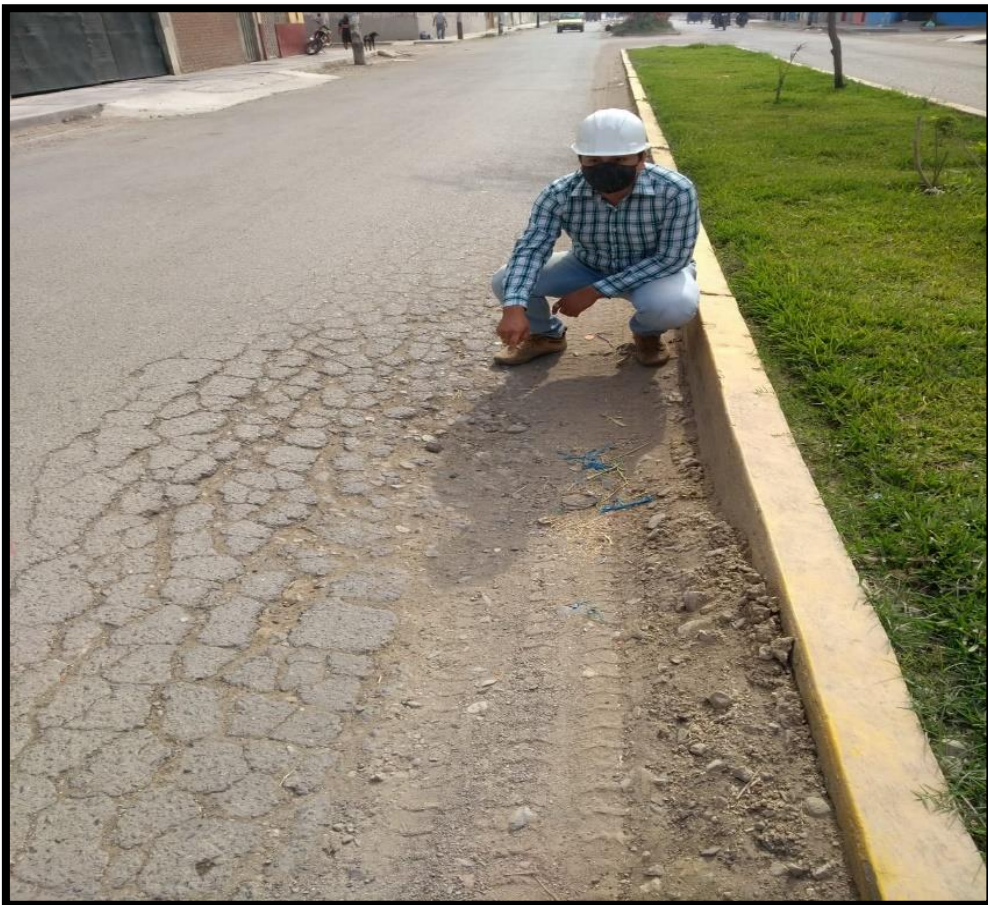
ILUSTRACIÓN 6: PIEL DE COCÓDRILO, AHUPELLAMIENTO Y DESPRENDIMIENTO DE MATERIALES.
