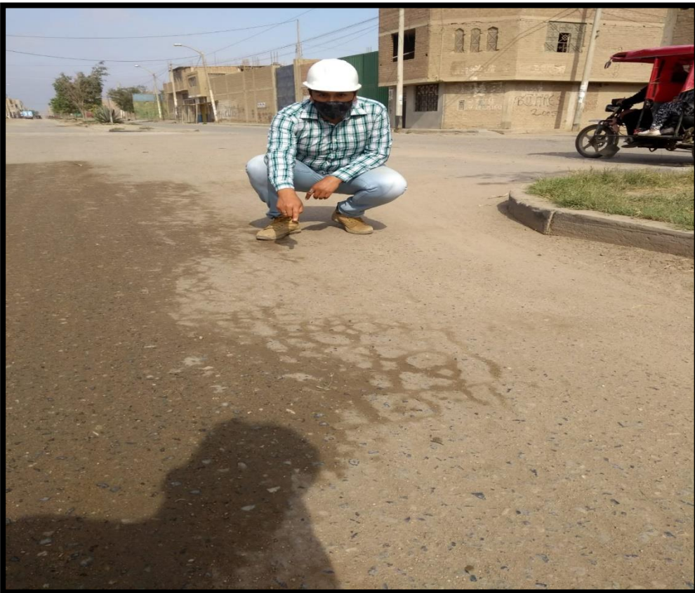
ILUSTRACIÓN 32: PIEL DE COCODRILO, PULIMIENTO DE AGREGADOS.
