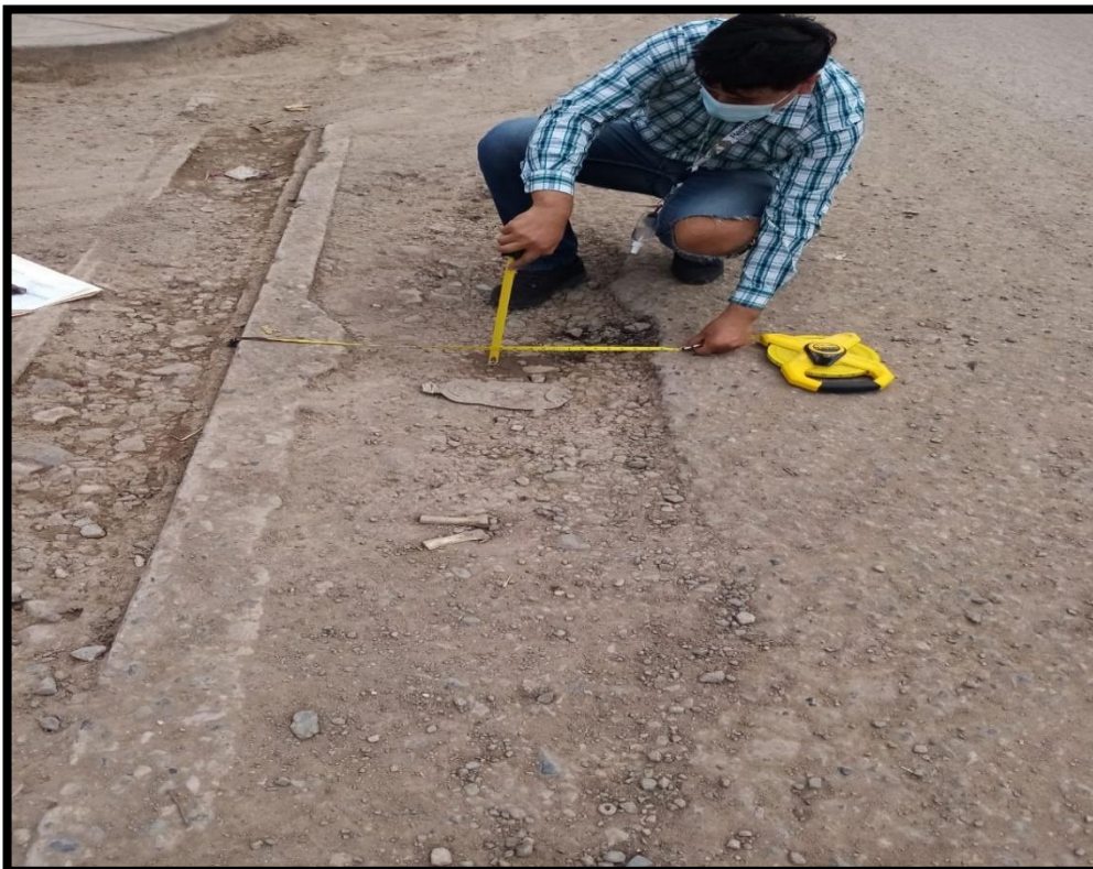
ILUSTRACIÓN 58: HUECO, GRIETA DE BORDE.
