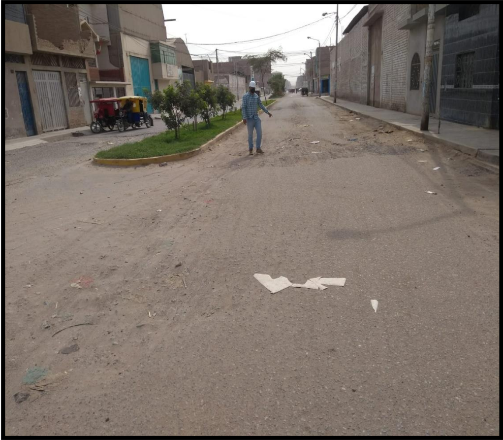
ILUSTRACIÓN 37: AGRIETAMIENTO, HUNDIMIENTO, DESPRENDIMIENTO DE AGREGADOS.
