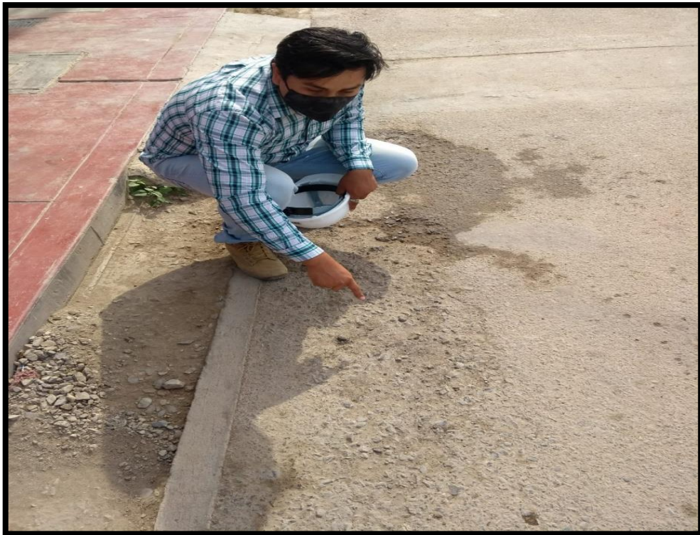
ILUSTRACIÓN 4: DESPRENDIMIENTO DE AGREGADOS
