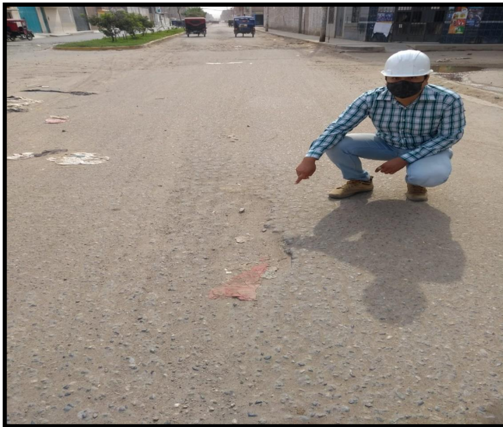
ILUSTRACIÓN 36: HUECO, PULIMIENTO DE AGREGADOS.
