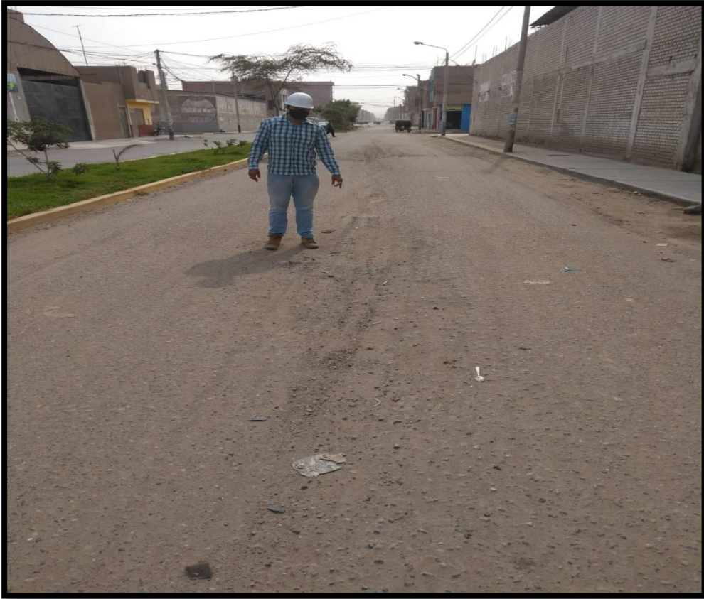
ILUSTRACIÓN 31: AGRIETAMIENTO, DESPRENDIMIENTO DE AGREGADOS, PULIMIENTO DE AGREGADOS.
