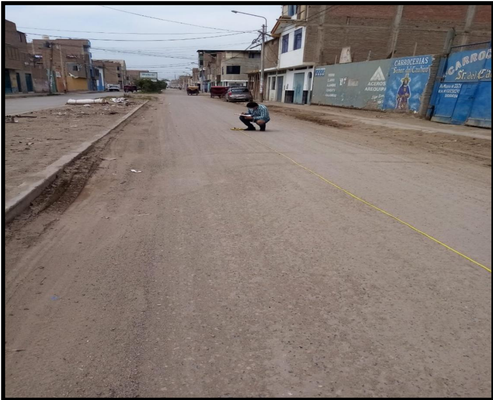
ILUSTRACIÓN 52: CORRUGACIÓN, GRIETA PARABÓLICA, PULIMIENTO DE AGREGADOS.
