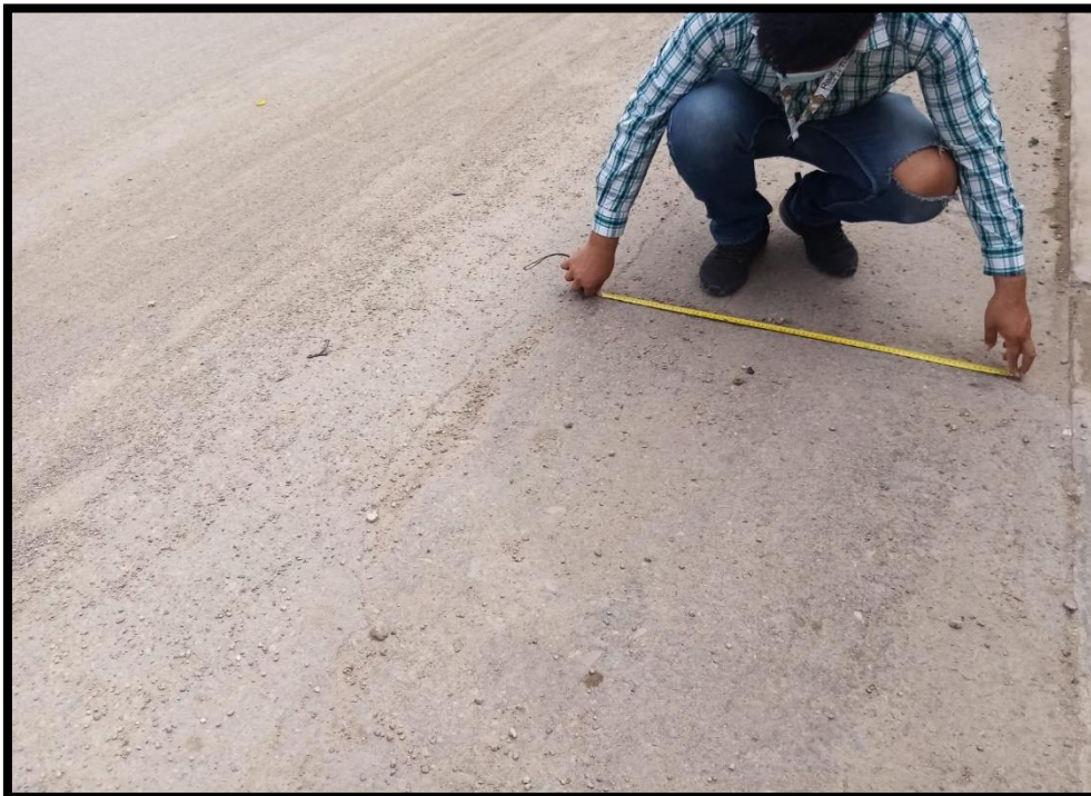
ILUSTRACIÓN 54: GRIETA DE BORDE, GRIETA LONGITUDINAL, PARCHEO.
