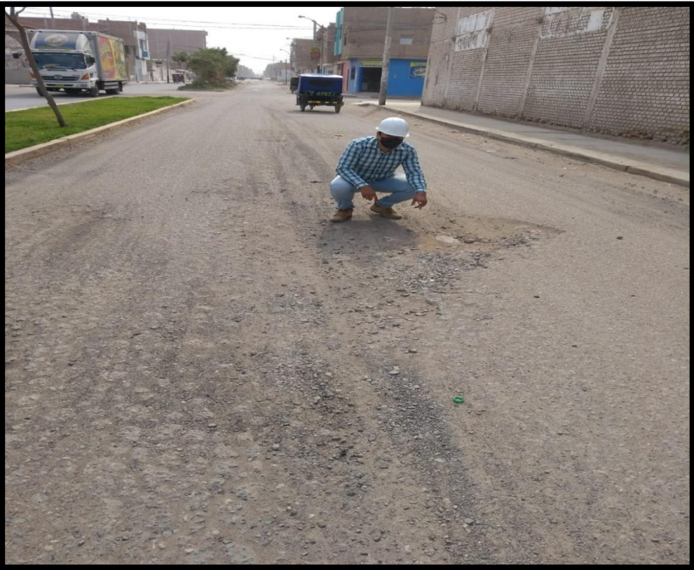
ILUSTRACIÓN 38. DESPRENDIMIENTO DE AGREGADOS, AGRIETAMIENTO EN BLOQUE, HUNDIMIENTO.
