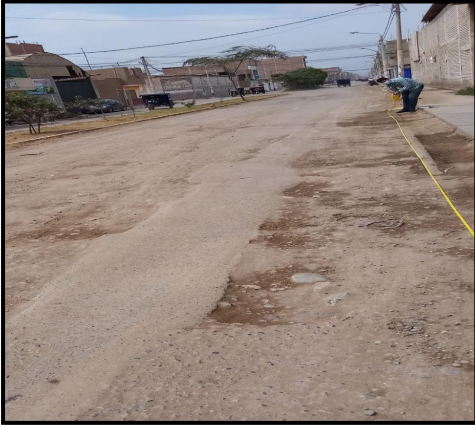
ILUSTRACIÓN 55: PARCHEO, CORRUGACIÓN, DESPRENDIMIENTO DE AGREGADOS, HUECO.
