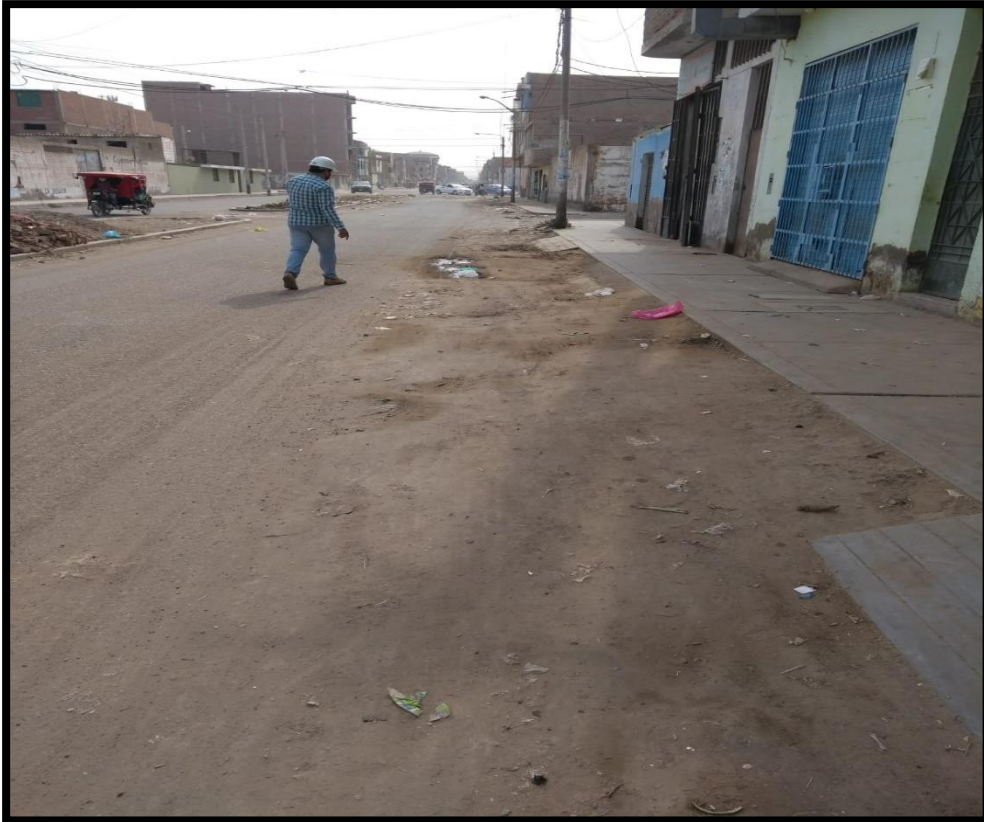
ILUSTRACIÓN 39: PULIMIENTO DE AGREGADOS, HUNDIMIENTO.
