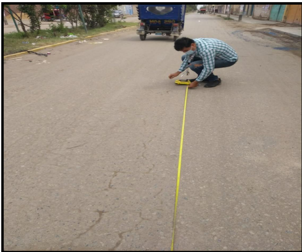
ILUSTRACIÓN 21: AGRIETAMIENTO EN BLOQUE.
