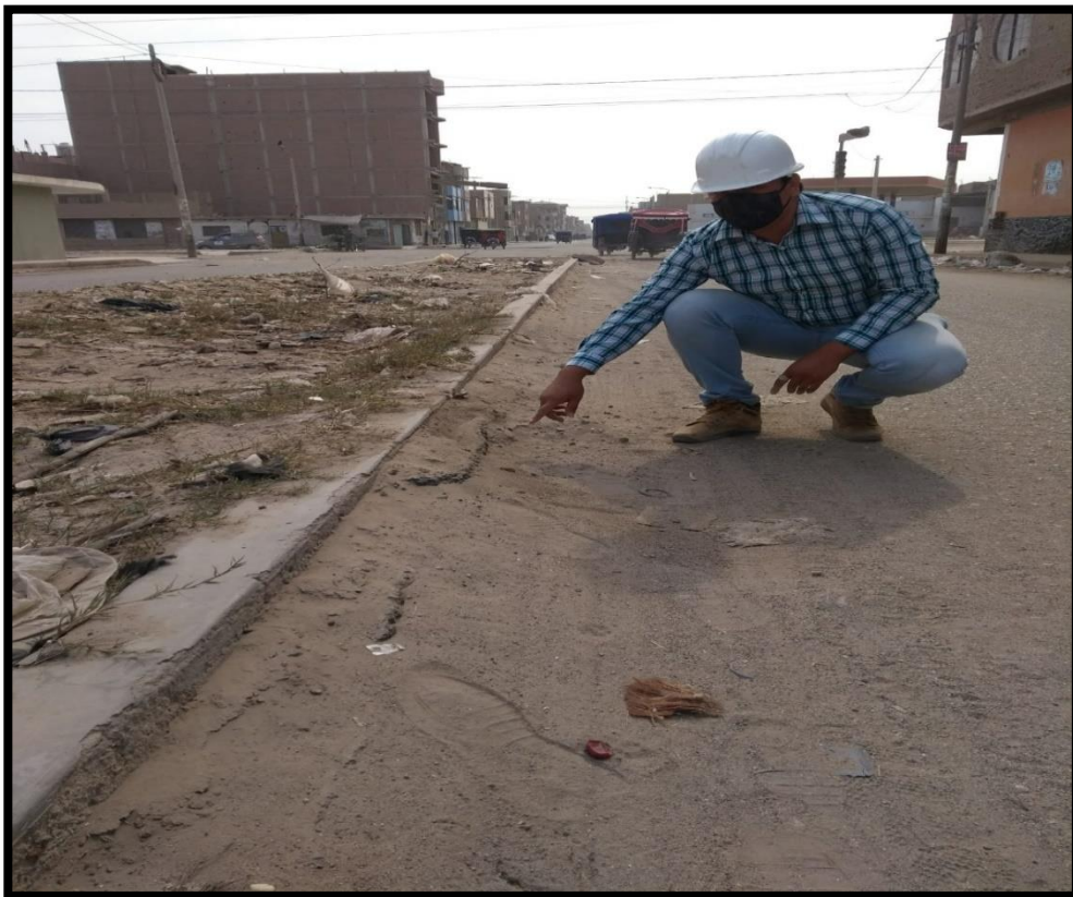
ILUSTRACIÓN 42: HUNDIMIENTO, PULIMIENTO DE AGREGADOS.
