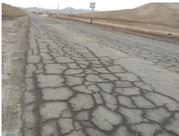
Figura 19. Falla piel de cocodrilo con severidad alta
