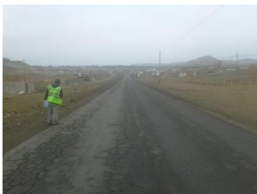
Figura 17. Reconocimiento de las fallas
