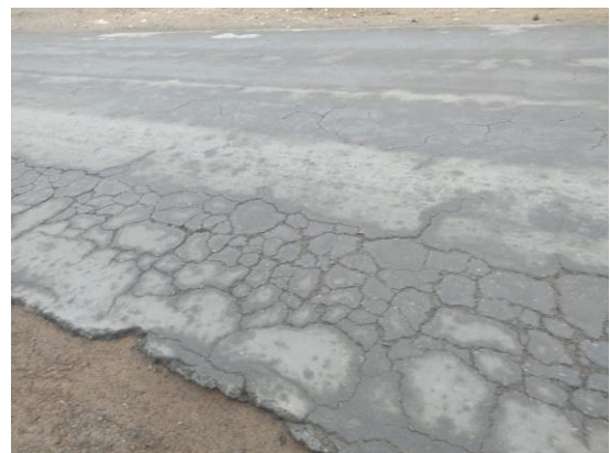
Fotografía 6. Falla de Rotura de borde y piel de cocodrilo.
