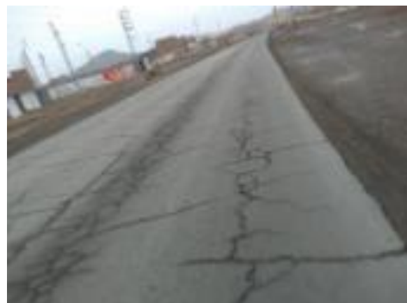
Figura 20. Falla de grieta longitudinal y transversal con severidad media.
