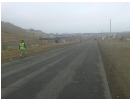
Fotografía 5. Reconocimiento de fallas y su severidad.
