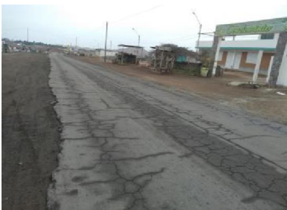
Figura 21. Falla de grieta de bordes identificada en la U6.
