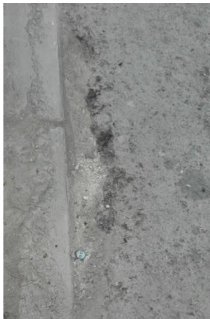
Figura 7. Rotura de bordes
