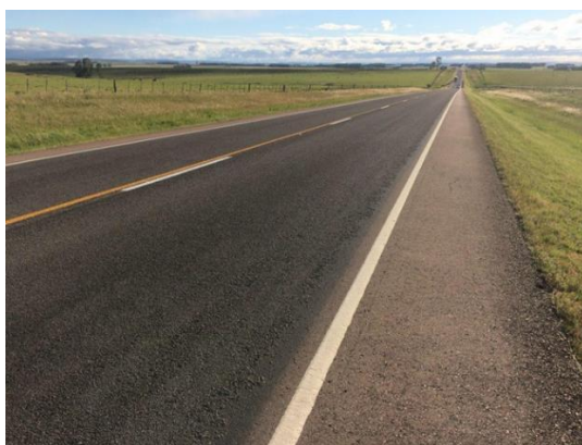
Figura 3. Falla de ahuellamiento
