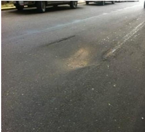
Figura 4. Falla de hundimiento
