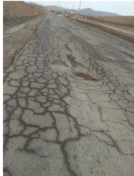
Fotografía 4. Falla piel de cocodrilo con severidad alta
