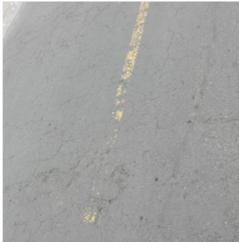
Figura 6. Fisura tipo piel de cocodrilo
