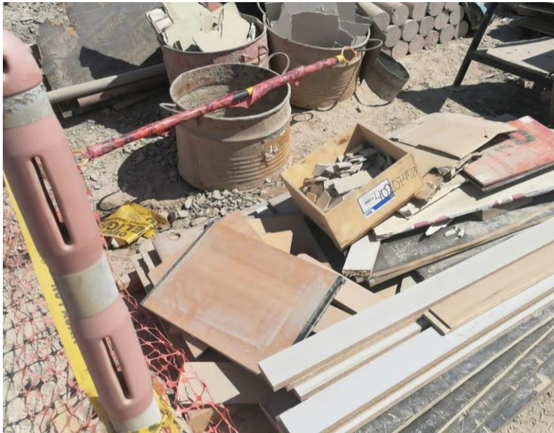
Figura 17. Desorden en el área de trabajo.
