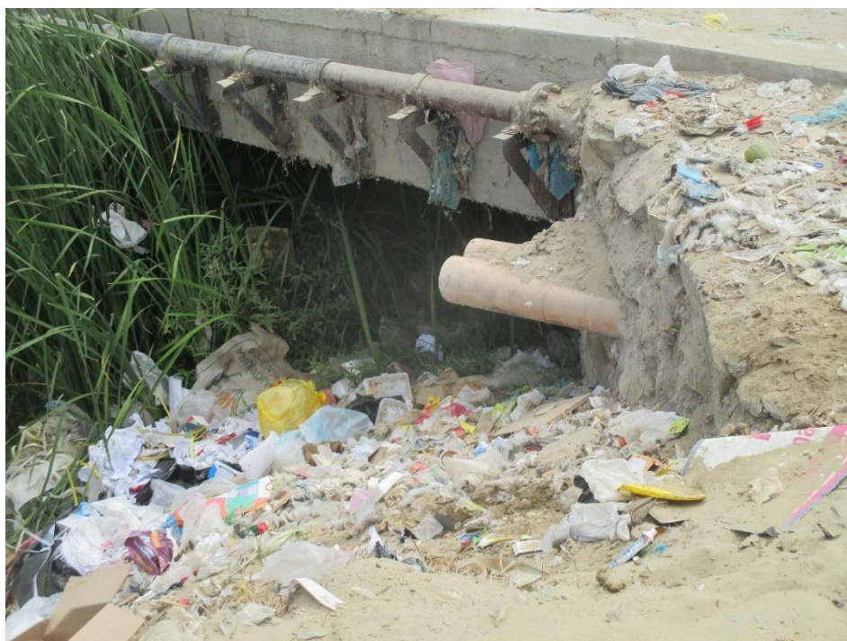
Figura 28. Contaminación de dren Japón - Intersección Calle 1 con Av. Francia
