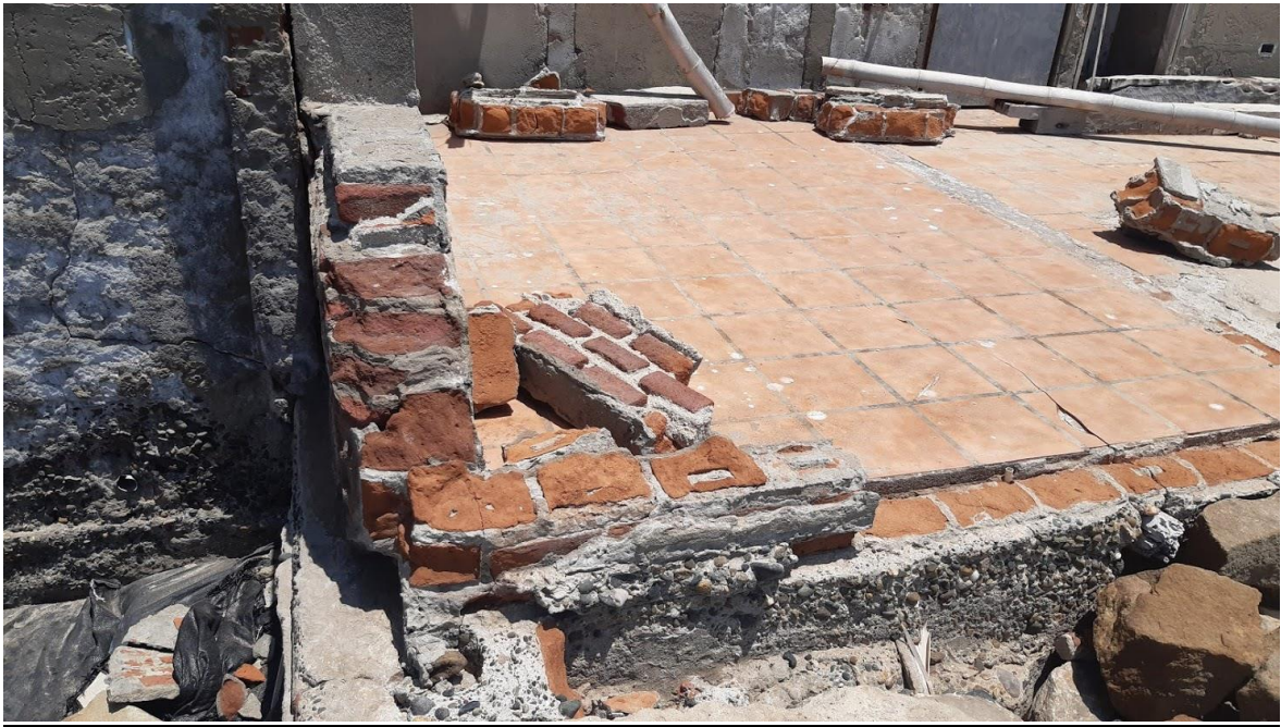
Figura 12: Terraza afectada por la erosión costera.
