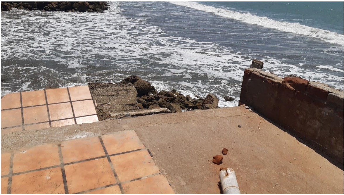
Figura 13: Derrumbe de pisos.
