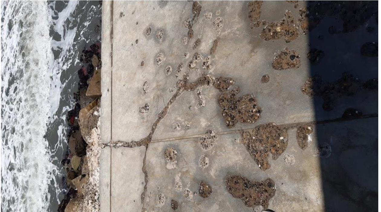
Figura 14: Degradación de materiales en las veredas expuestas al mar.
