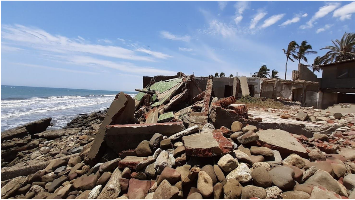
Figura 11: Vivienda ubicada frente al mar afectada por la erosión costera.
