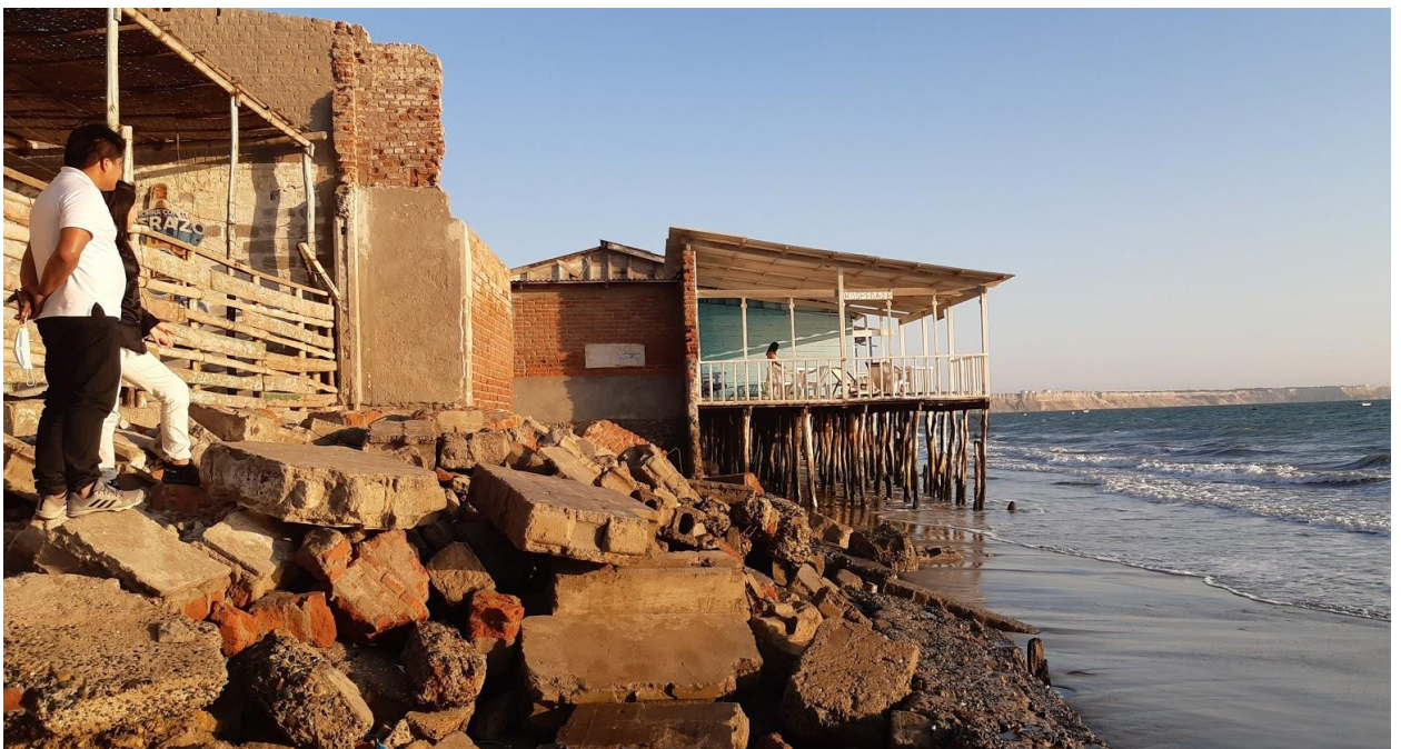
Figura 15: Derrumbe de muros en vivienda frente al mar.
