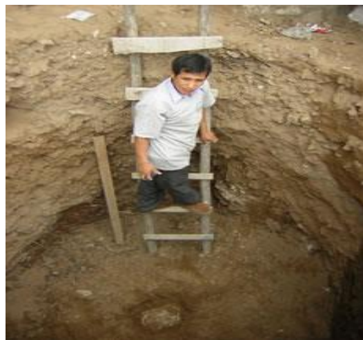
Biodigestor de 3,000 litros.
