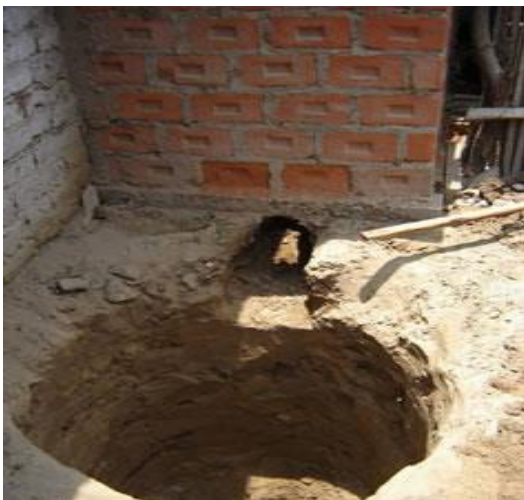
Biodigestor de 600 litros.
