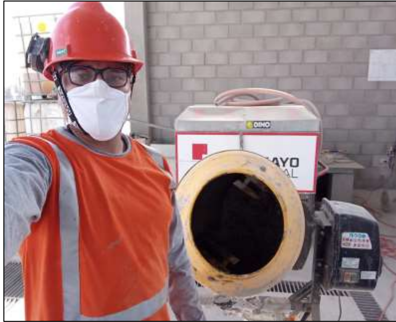
Fotografía n.º 07. Preparación de la mezcla de concreto autocompactante – Tanda de prueba.
