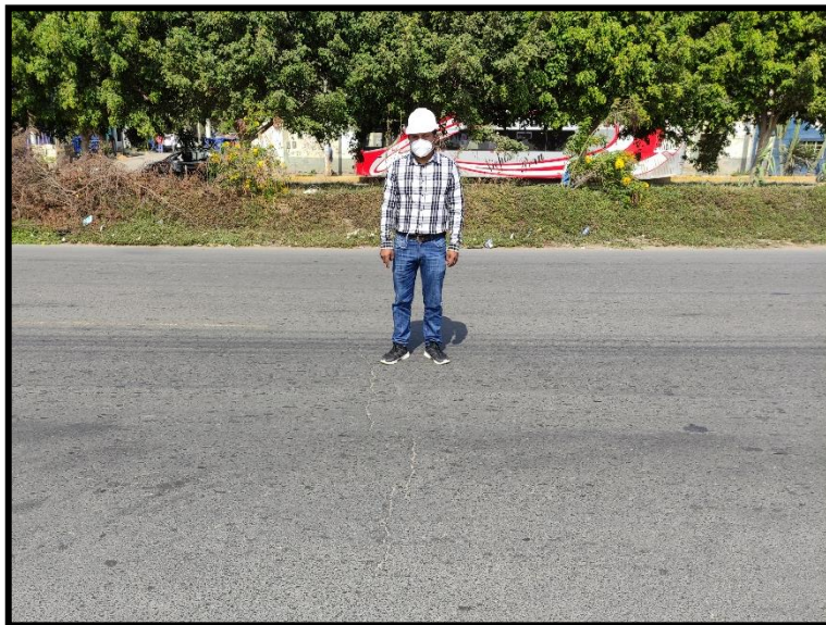
Foto N° 06: Tipo de falla Transversal en la Av. Fitzcarrald.
