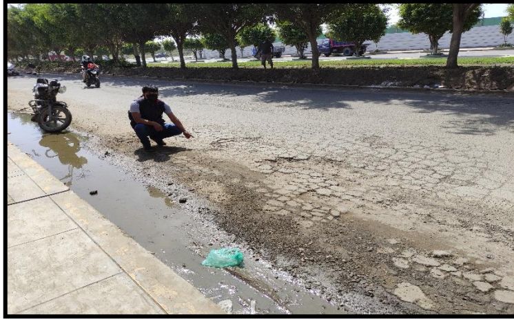
Foto N° 03: Tipo de falla Piel de cocodrilo en la Av. Fitzcarrald.
