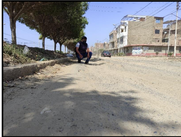
Foto N° 04: Tipo de falla Ahuellamiento en la Av. Fitzcarrald.
