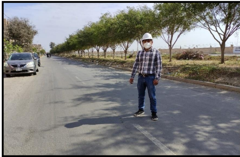
Foto N° 02: Tipo de falla Grieta longitudinal en la Av. Fitzcarrald.
