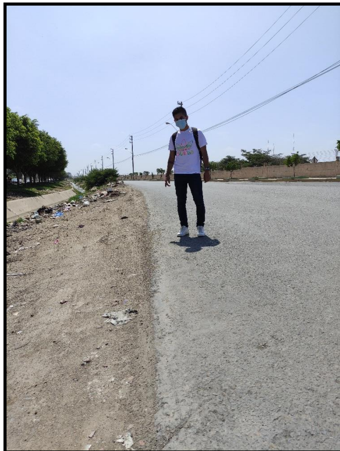
Foto N° 08: Tipo de falla Desnivel de Carril/Berma en la Av. Fitzcarrald.
