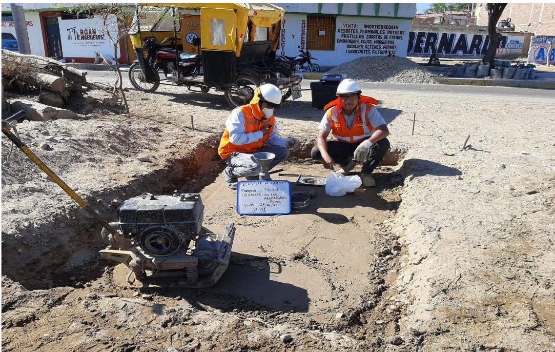
Figura 24. Ensayo de Densidad IN SITU cono de Arena a Nivel de Subrasante.
