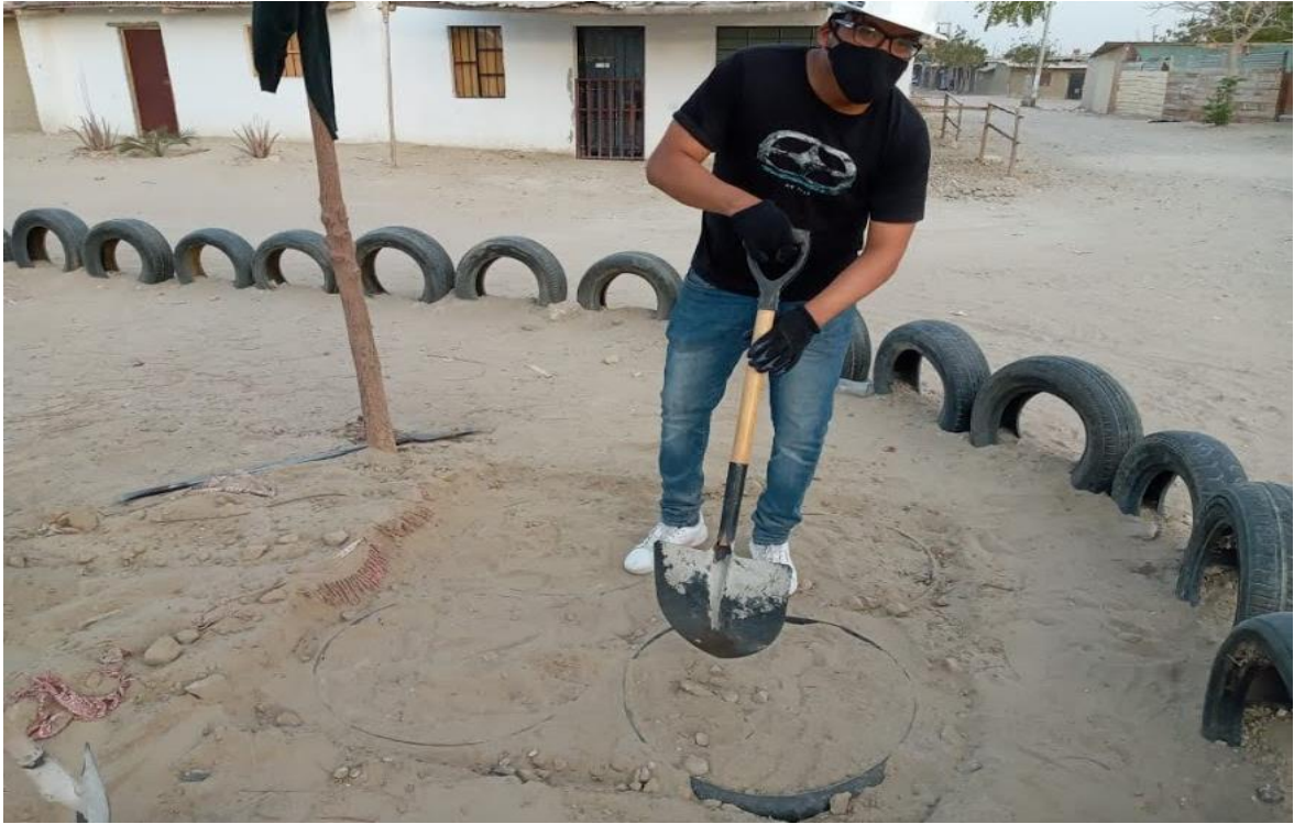
Figura 15. Relleno de los geocilindros de neumáticos hasta el nivel encontrado y compactado manual del material.
