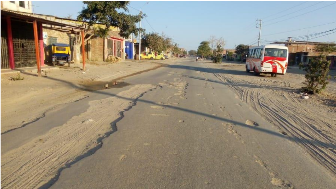
Figura 1. Vista del pavimento en la Av. Los Algarrobos donde se aprecia diferentes fallas.
