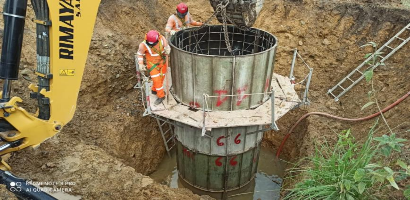
Se observa la presencia de Napa freática superficial y el proceso de encofrado para un buzón fabricado in situ.
