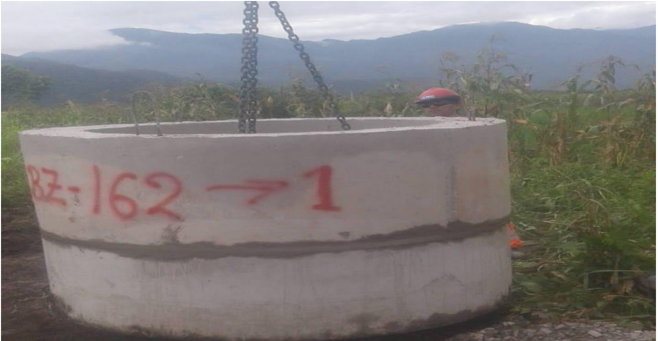
Se observa en la imagen el proceso constructivo para la instalación de la base y el cuerpo de un buzón prefabricado con una junta de construcción (mortero 210 kg/cm 2 )
