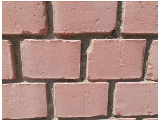
Figura N° 25. Muro de cabeza en mal estado- Pabellón A
