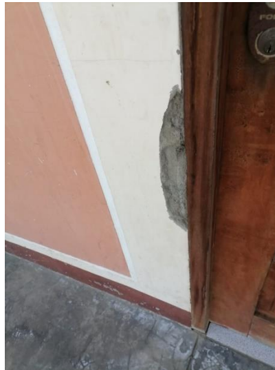
Figura N° 26. Grieta en Columna – Pabellón E
