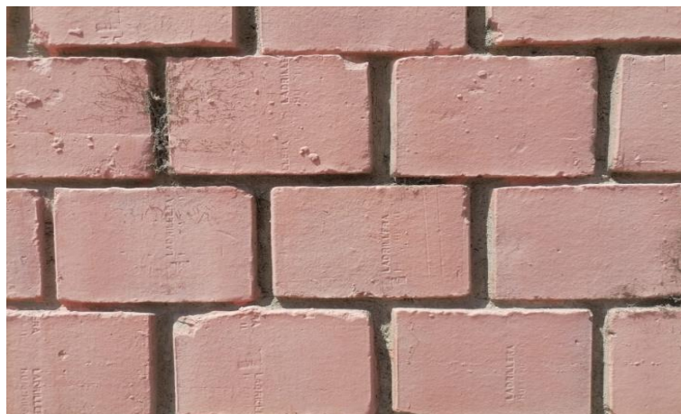
Figura N° 10..Asentado de ladrillo de cabeza y mortero en malas condiciones – Pabellón A
