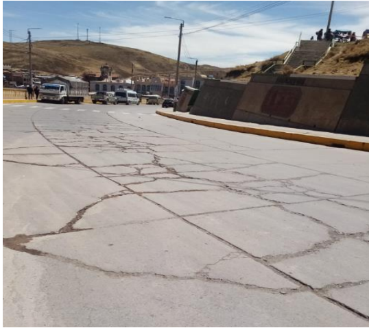
Figura 1.1. Deterioro del Pavimento rígido
