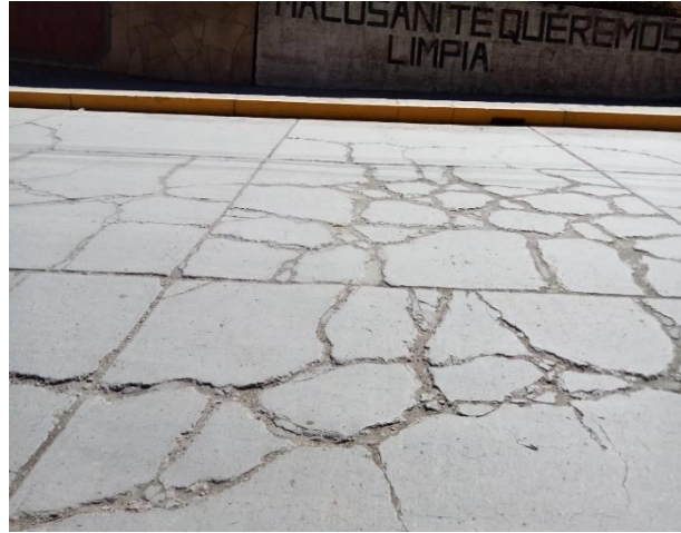
Figura 1.2. Agrietamiento del pavimento rígido
