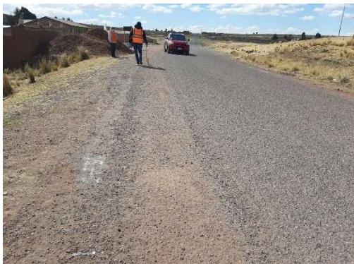
Desprendimiento de agregados
