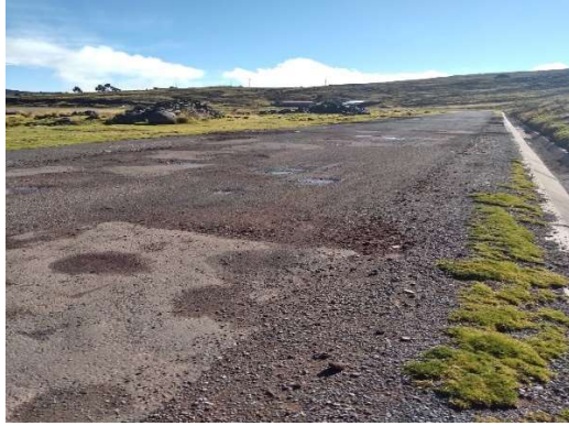
Desprendimiento de agregados
