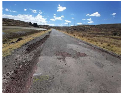
Abultamiento y hundimiento
