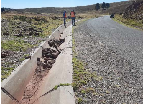
Desprendimiento de agregados de baja severidad
