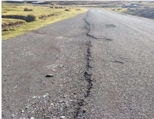
Grietas de borde de alta severidad alta
