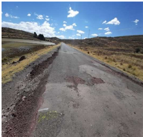
Figura 1. Carretera Atuncolla-Desprendimiento de agregados
