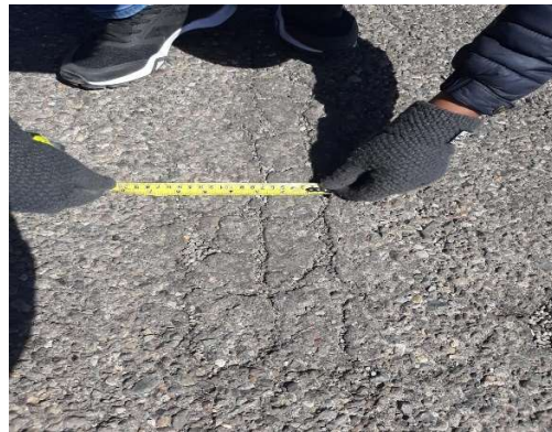
Fisuras de piel de cocodrilo de severidad baja
