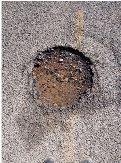
Figura 2. Carretera Atuncolla – Hundimiento
