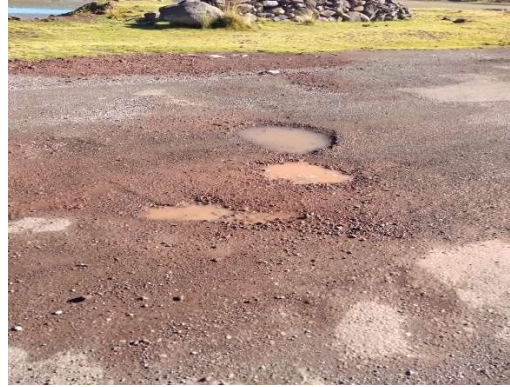
Huecos de alta severidad
