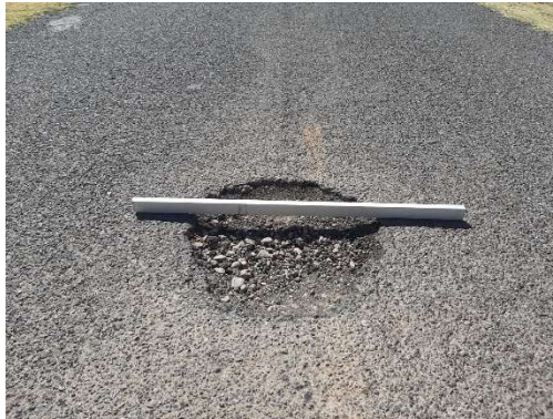
Huecos de alta severidad
