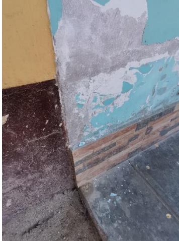
Anexo 37: Desprendimiento Del Concreto
