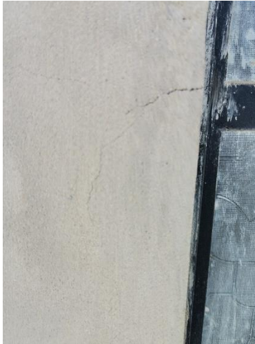
Anexo 34: Fisuras Y Humedecimiento
