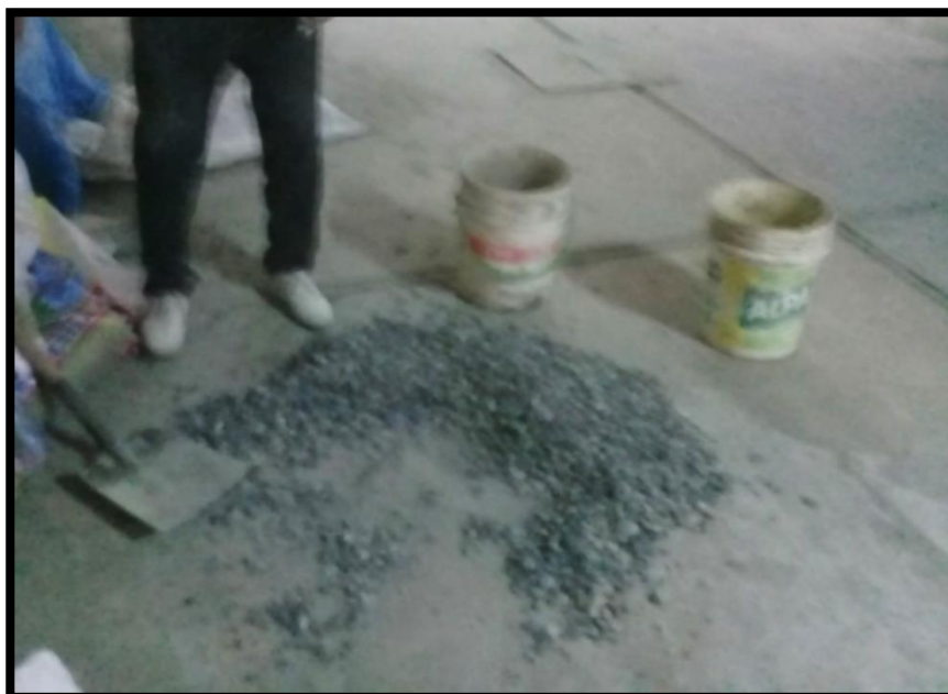
Foto N°30: Materiales y equipos para dosificación
