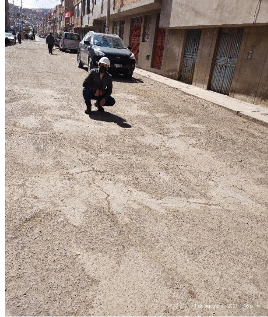
Foto N° 04 Peladura por intemperismo, severidad media.
