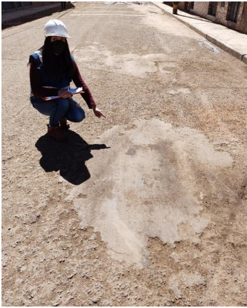
Foto N° 07 Exudación, severidad media.
