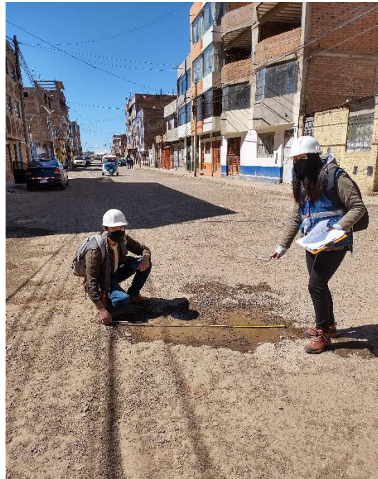
Foto N° 17 Bache, severidad baja.
