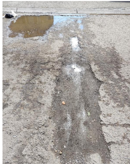
Foto N° 20 Peladura por intemperismo y bache, severidad alta.
