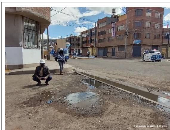
Foto N° 01 Baches, severidad alta.
