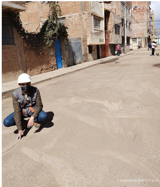
Foto N° 07 Fisuras en bloque, severidad media
