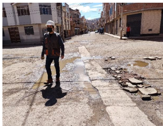
Foto N° 07 Parches, y baches, severidad alta.
