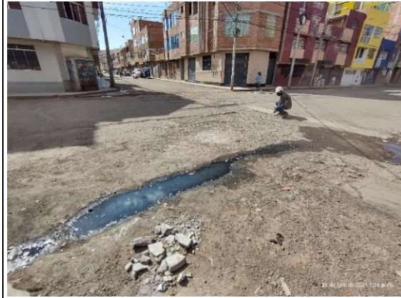
Foto N° 16 Peladura por intemperismo y bache
