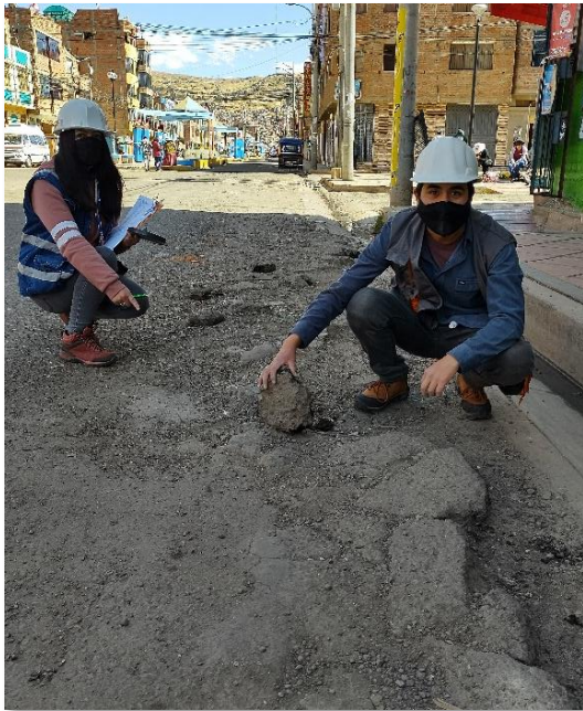
Foto N° 13 Peladura por intemperismo y destrucción del pavimento, severidad alta.
