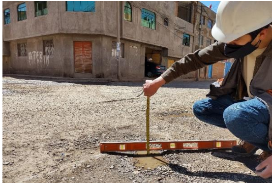
Foto N° 17 Bache, severidad baja.
