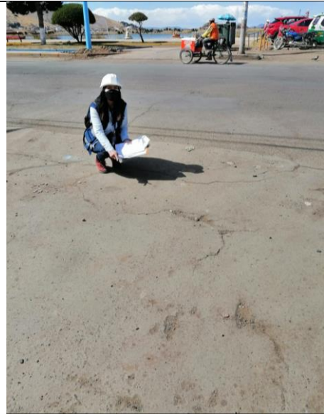
Foto N° 07 Fisuras en bloque, severidad baja.
