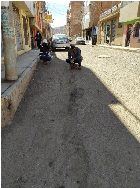
Foto N° 06 Fisura longitudinal, severidad alta.
