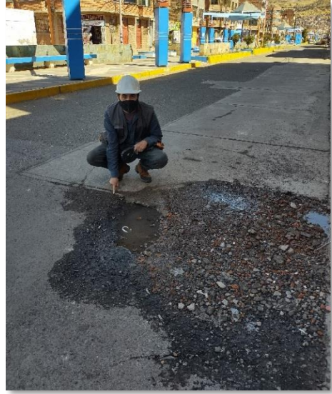
Foto N° 12 Bache y parche, severidad alta.
