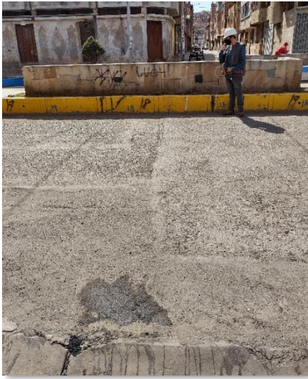
Foto N° 11 Peladura por intemperismo, severidad media.
