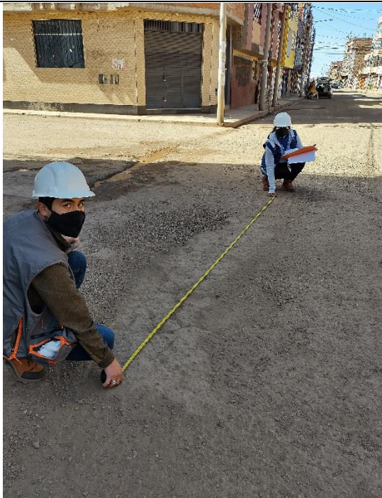
Foto N° 19 Parche, severidad media.
