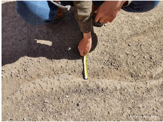
Foto N° 06 Fisura longitudinal, severidad baja.
