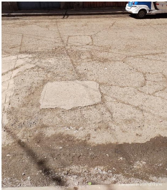
Foto N° 07 Parches y fisuras en bloque, severidad media.
