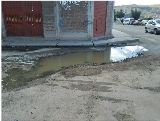
Foto N° 15 Bache, severidad alta.
