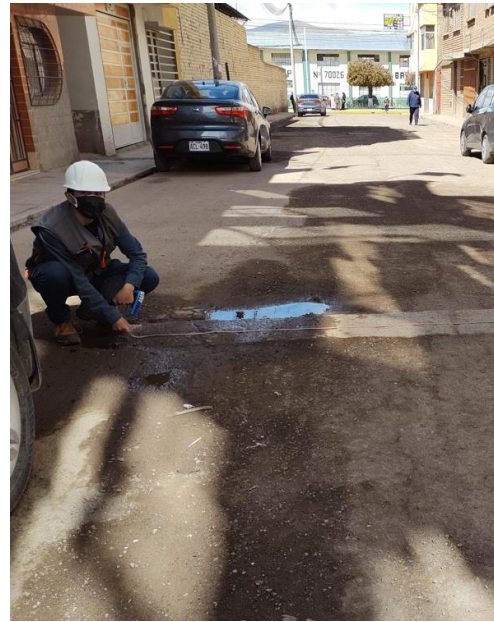
Foto N° 08 Parche, severidad media.
