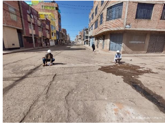
Foto N° 19 Parche, severidad media.
