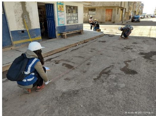
Foto N° 19 Parche, severidad media.
