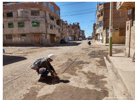
Foto N° 20 Peladura por intemperismo, severidad media.
