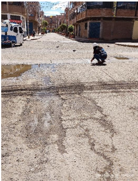
Foto N° 20 Peladura por intemperismo, severidad media.
