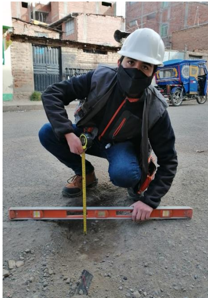
Foto N° 17 Bache, severidad baja.
