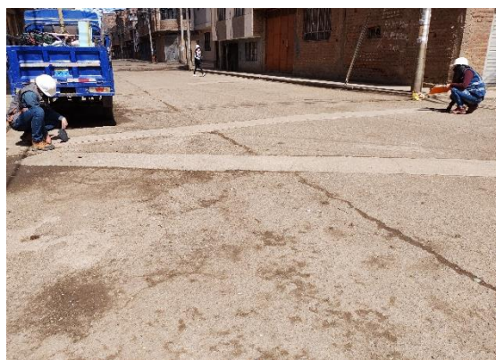
Foto N° 07 Parches, severidad alta.
