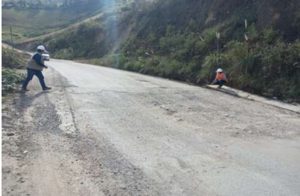
FOTO N° 03: Fallas grietas longitudinales
