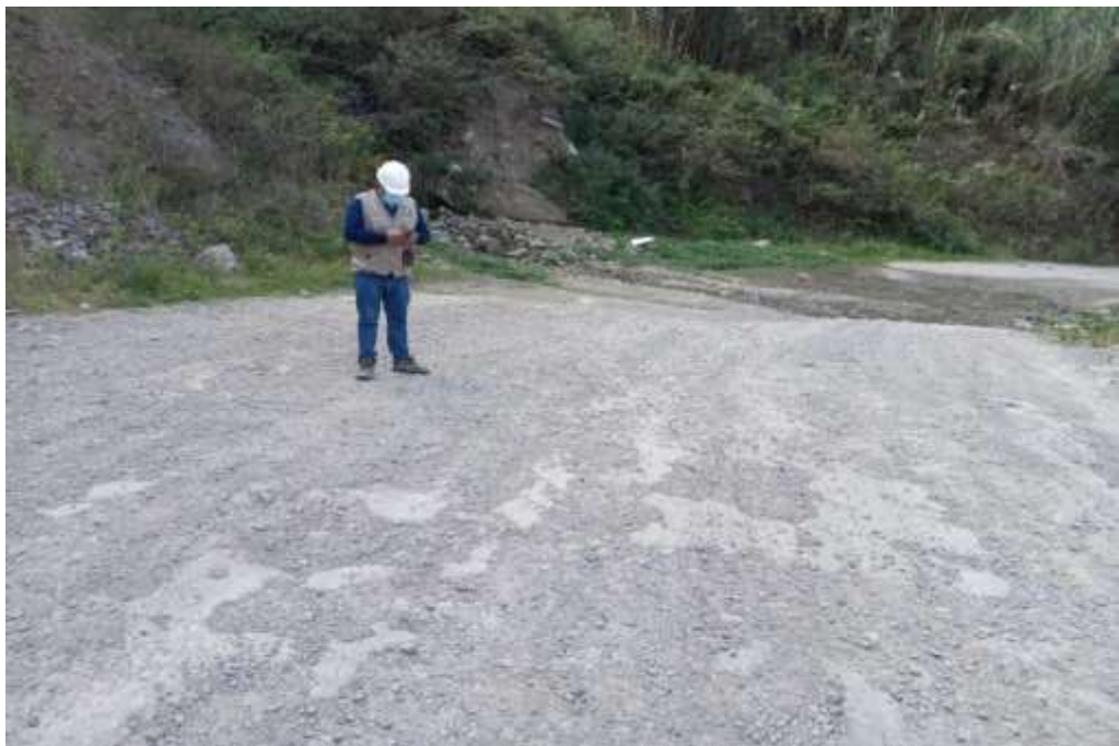
FOTO N° 02: Falla piel de cocodrilo severidad alta
