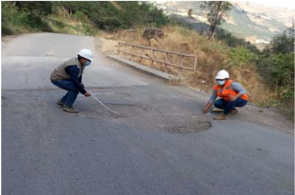
FOTO N° 01: Fallas huecos en la vía.
