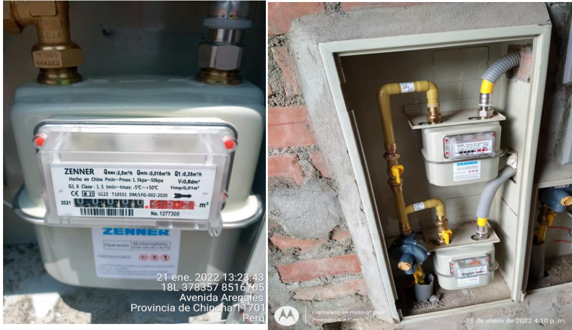
Instalación regulador y medidor
