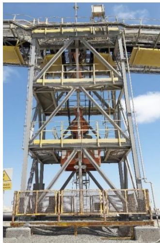
Figura 29. Contrapeso de faja TR 1090-02 en buen estado
