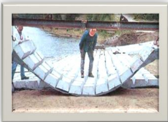
Figura 27. Sistema cable concreto.
