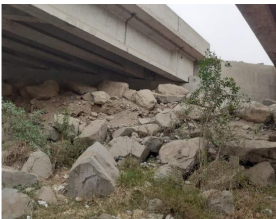
Fotografía 11. Defensa ribereña con Enrocado arrastrado por la fuerza del agua puente San Martín carabaylo rio chillón.
