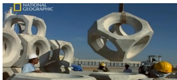
Figura 5. Bloques de concreto hueco utilizados alrededor de la base del hotel Burj al Arab en protección contra las olas, (Fuente: National Geographic, 2016).
