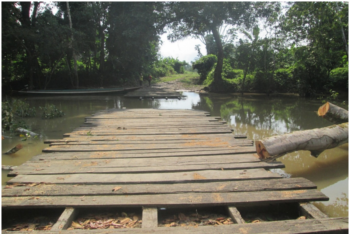
Foto 06: Quebrada del Caserío Shinuya
