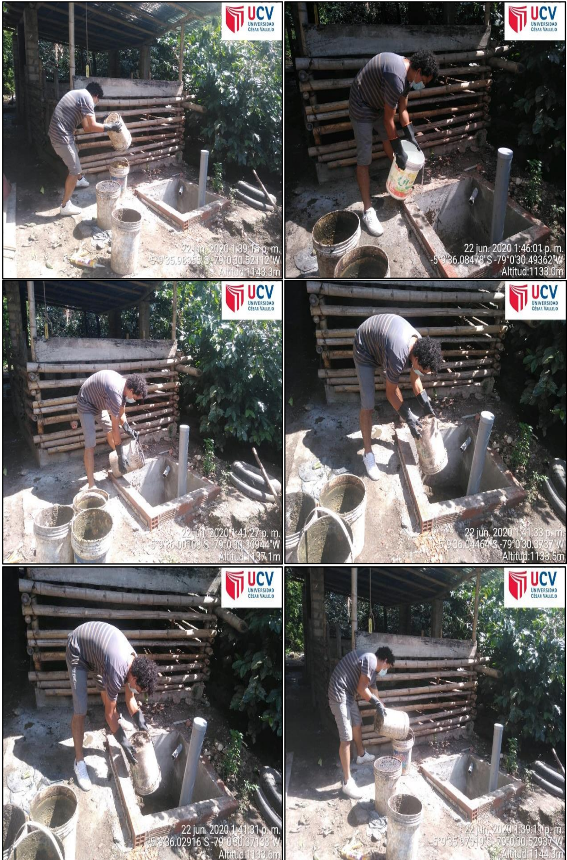
Figura 15. Llenado del biodigestor
