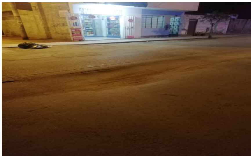
Figura N° 13: Situación actual del Pavimento. Fuente: Elaboración propia.
