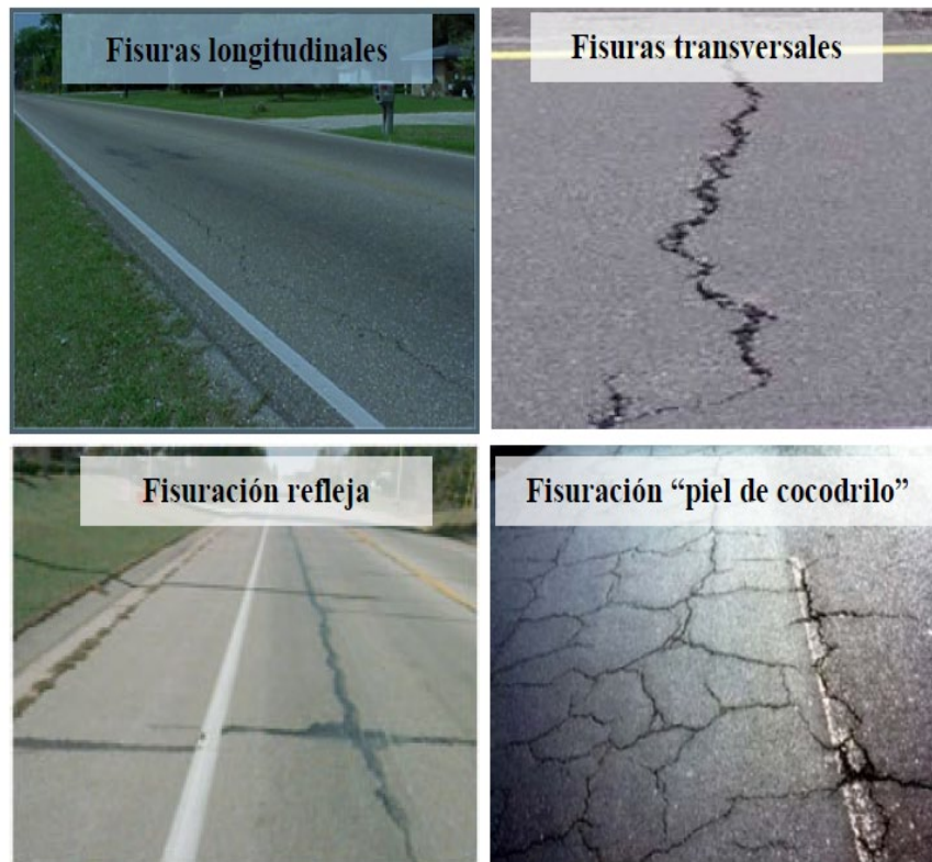
Figura N° 5: Tipo de Fisuras en el pavimento asfáltico. Fuente: Deformación Permanente en Mezclas Asfálticas, 2011
