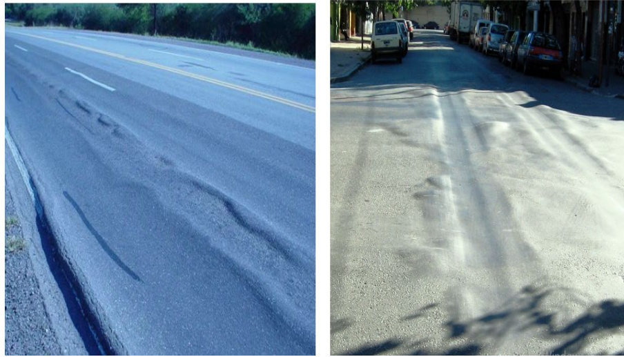
Figura N° 6: Deformación Permanente. Fuente: Fuente: Deformación Permanente en Mezclas Asfálticas, 2011
