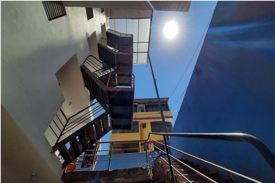
Foto 3: Vista interior, escalera y cobertura metálica sin refuerzos.
