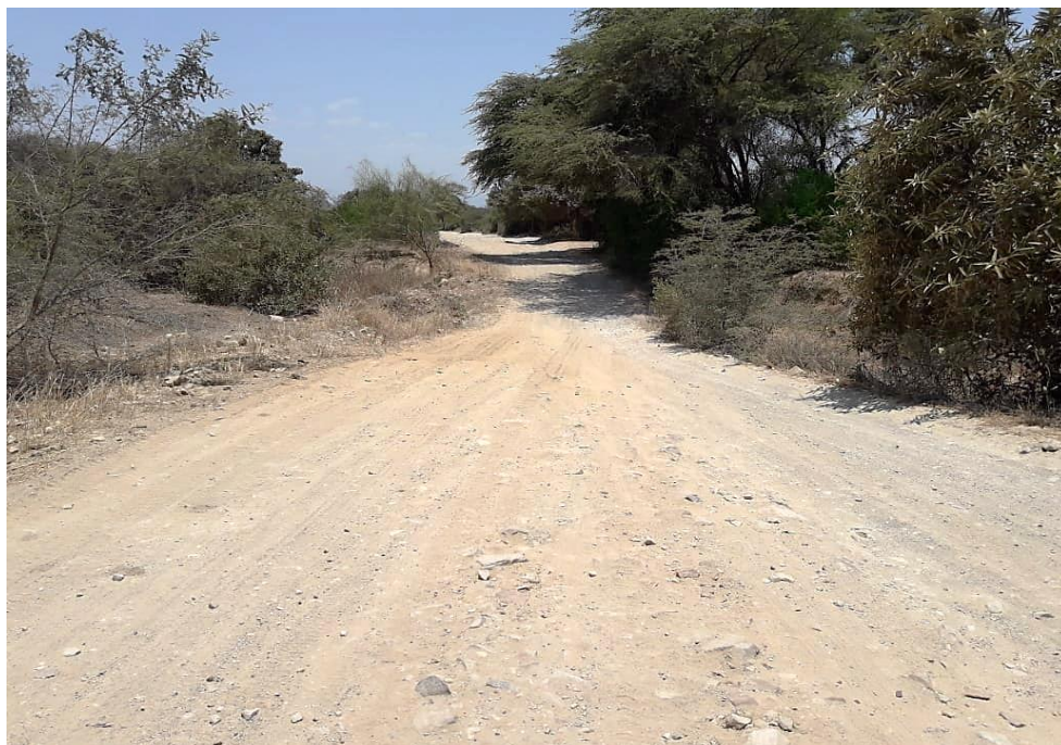
Figura 12. Trocha carrozable invadida por vegetación y la superficie de rodadura en mal estado.
