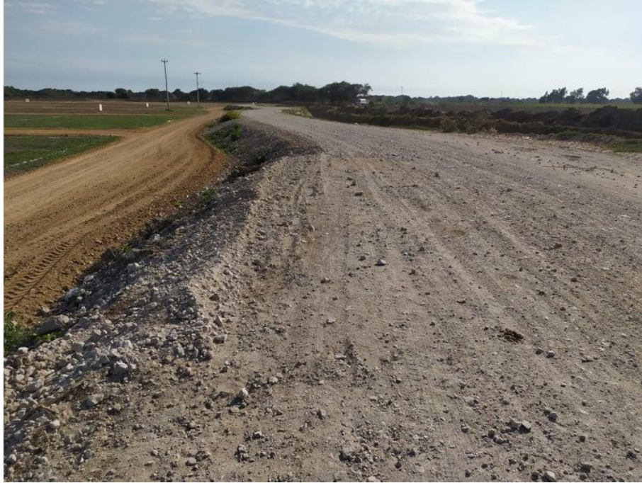
Figura 11. Ahuellamiento de la vía por el tránsito de vehículos.
