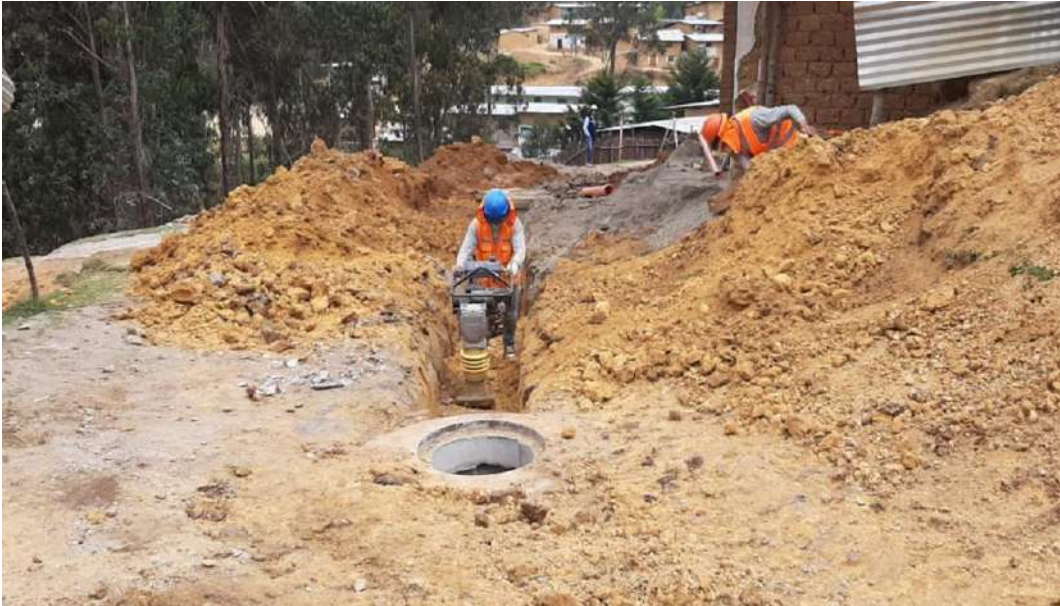
Figura 18: Vista de los trabajos de relleno y compactado de las zanjas de alcantarillado. Antes de rellenar con material propio se recubrió la tubería con arena en una altura de 40 cm.
