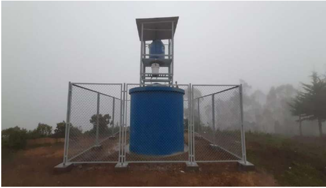
Figura 25: Vista de las estructuras de almacenamiento del Sistema de Agua Potable para los habitantes del Centro Poblado La Unión.
