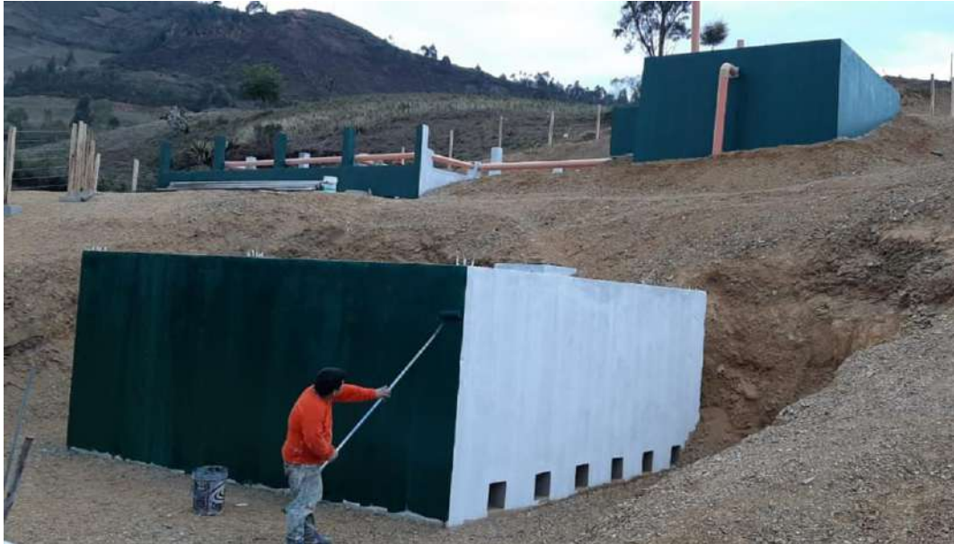
Figura 26: En la imagen se observa las estructuras de la Planta de Tratamiento: Tanque Imhoff, Lecho de Secado, Filtro Biológico, Cerco Perimétrico de alambre de púas.
