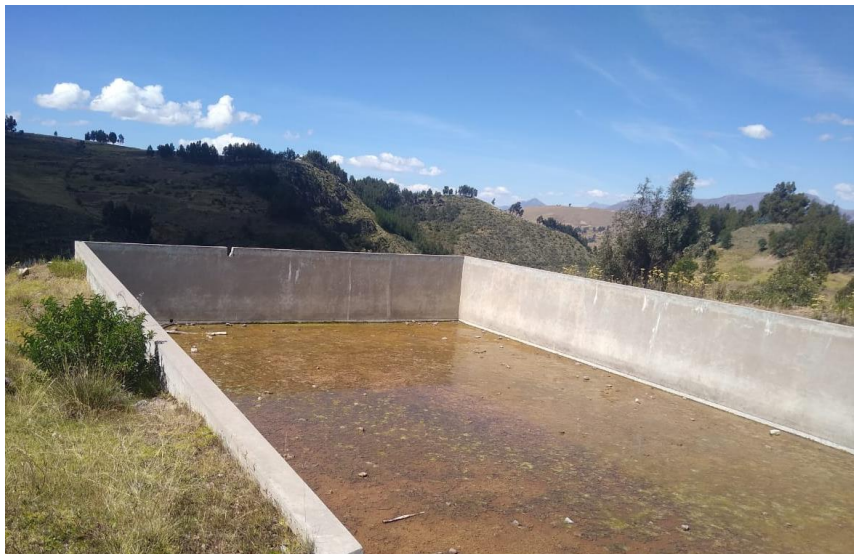
Figura 18. Punto de llegada (Reservorio)
