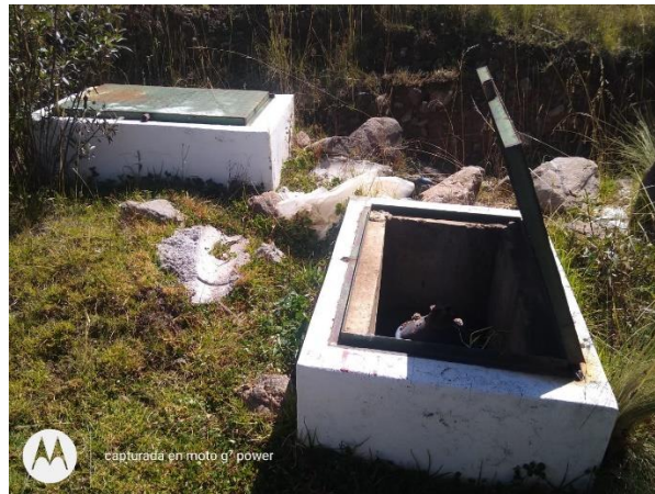
Figura 56. Instalaciones de riego tecnificado
