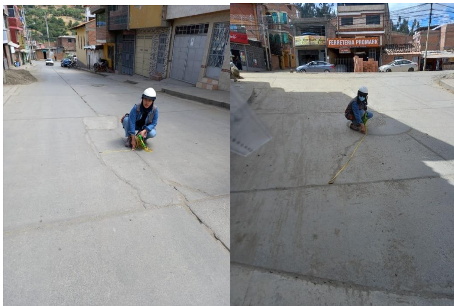
Figura 6. Patología en pavimentos rígido
