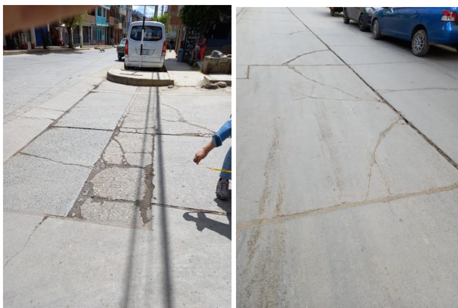
Figura 7. Patología en pavimentos rígido
