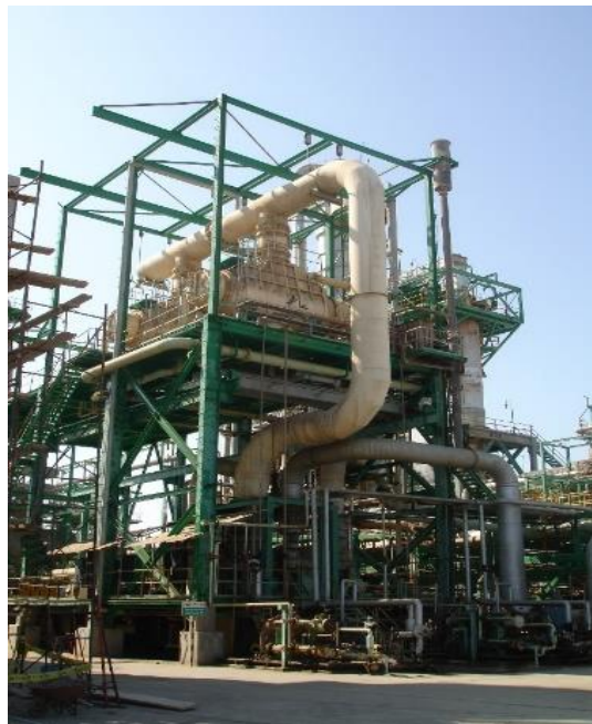
Figura N° 1 Compresor de aire a unidad de craqueo catalítico fluidizado
